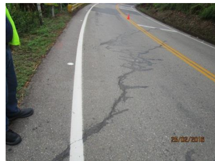
Figura No. 3: Fisura Transversal
