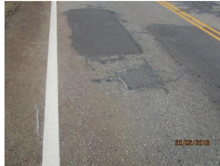
Figura No. 1: Intervención Previa Deteriorada
