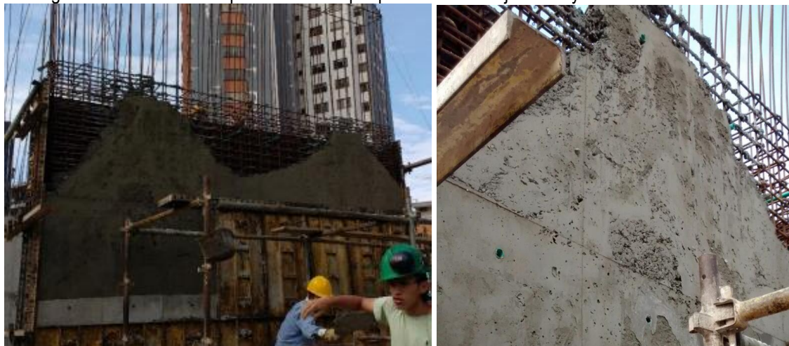
Figura 44. Pantalla 6 del piso 1 afectada por pérdida de manejabilidad y estabilidad del concreto
