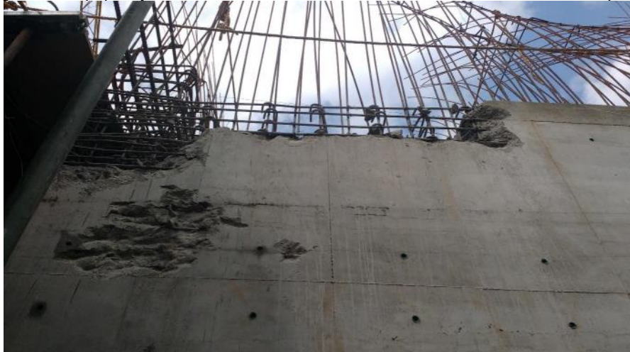
Figura 43. Apiques y demolición de la sección afectada del foso del ascensor del piso 1
