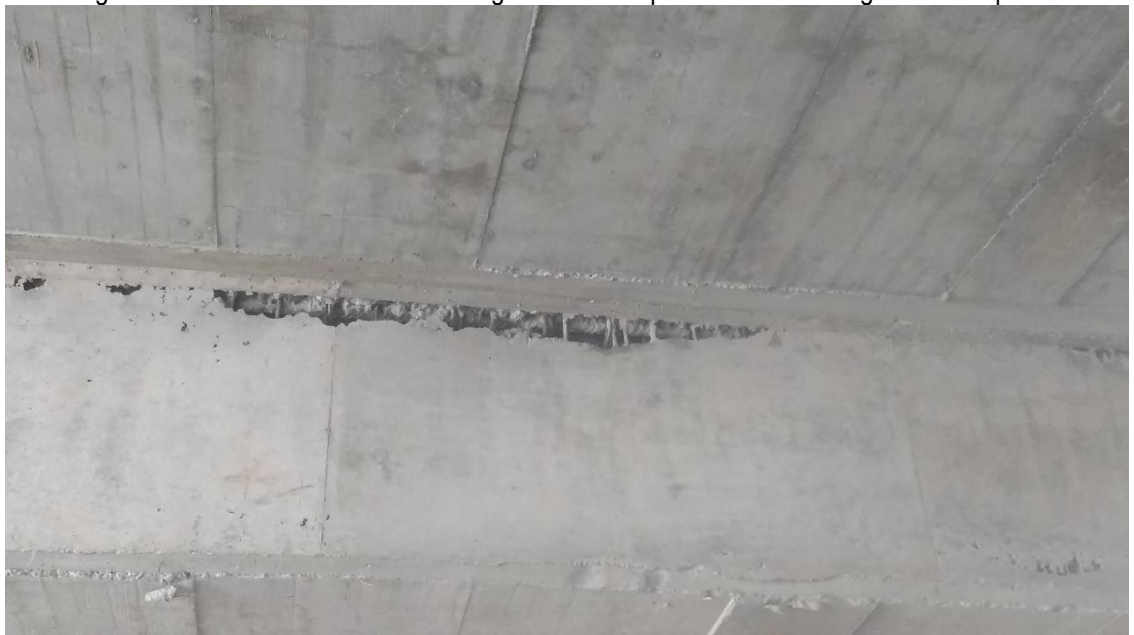
Figura 32. No conformidad 013. Hormigueros de alta profundidad en la viga 610A del piso 1
