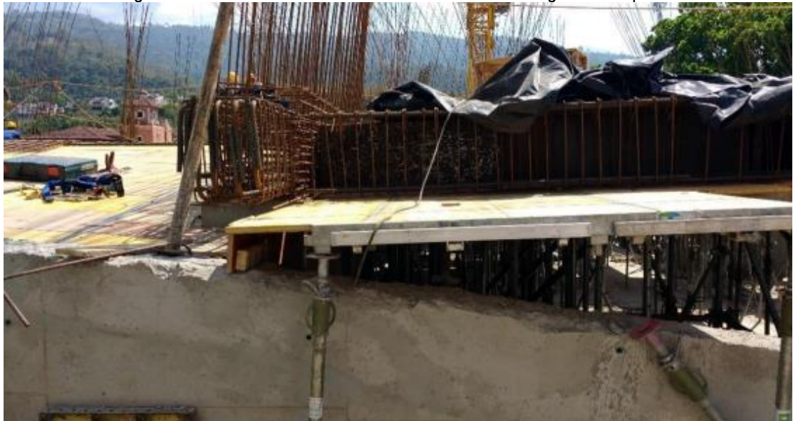
Figura 28. No conformidad 003. Mal entarimado de la viga 645 del piso 1
