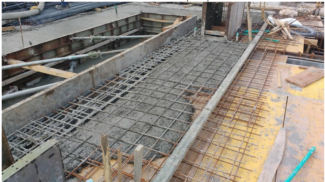
Figura 30. No conformidad 007. Placa del piso 1 parcialmente fundida
