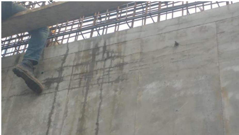
Figura 40. Fisuras en el foso del ascensor del Sótano 1
