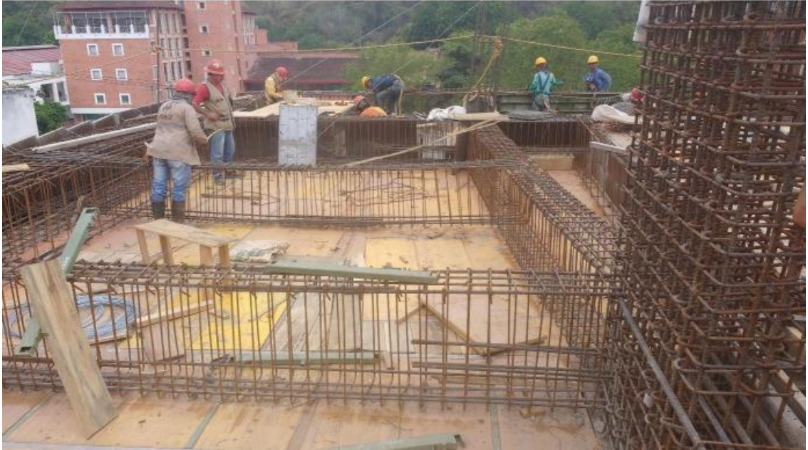
Figura 31. No conformidad 012. Viga 623 sin varillas de segunda fila
