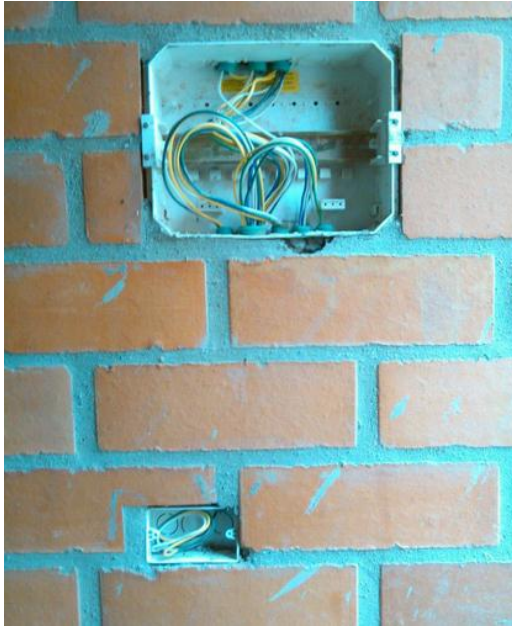
Figura 12: Alambrada de puntos eléctricos internos en los apartamentos.
