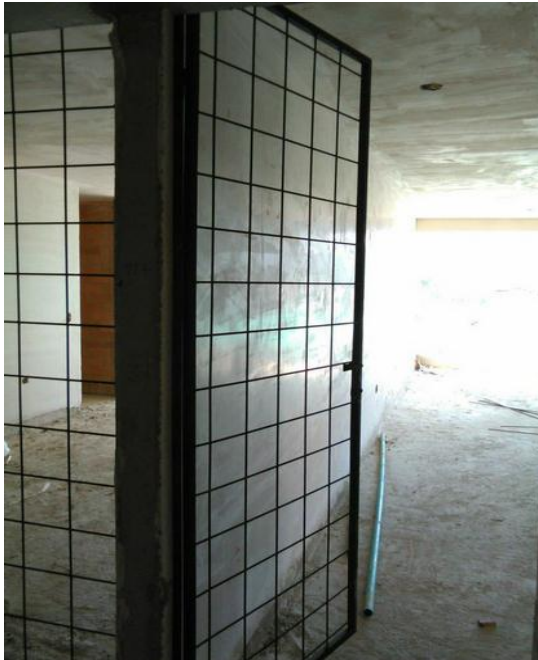
Figura 14: Puertas provisionales alzadas 10 cm del piso, de esta manera se da espacio para trabajar con mortero de nivelación e instalación de piso en cerámica.
