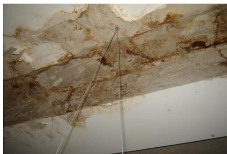
Figura 59. Se evidencian problemas de carbonatación y corrosión en elementos estructurales.
