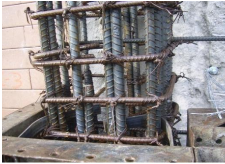
Figura 118. Detalle de los aceros en la columna, y de los estribos debidamente amarrados con alambre negro.
