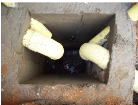
Figura 57. Caja de Desagües
