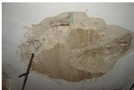
Figura 2. Perforaciones en el sector de salida de cables del túnel.
