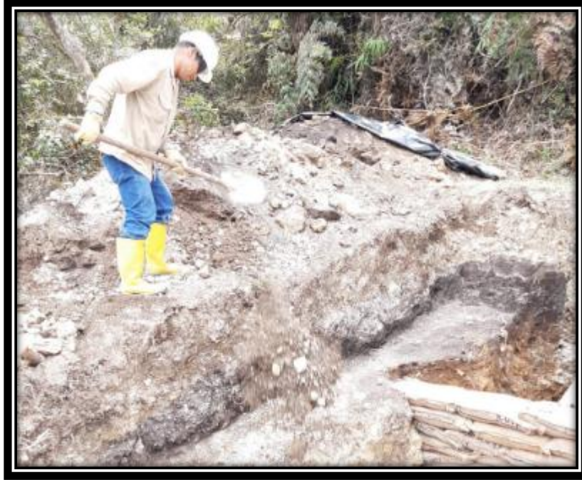
Ilustración 11. Contrato en Huila, Neiva, vereda Neiva, Supervisor Abel Aguilar, relleno con saco suelo cemento.
