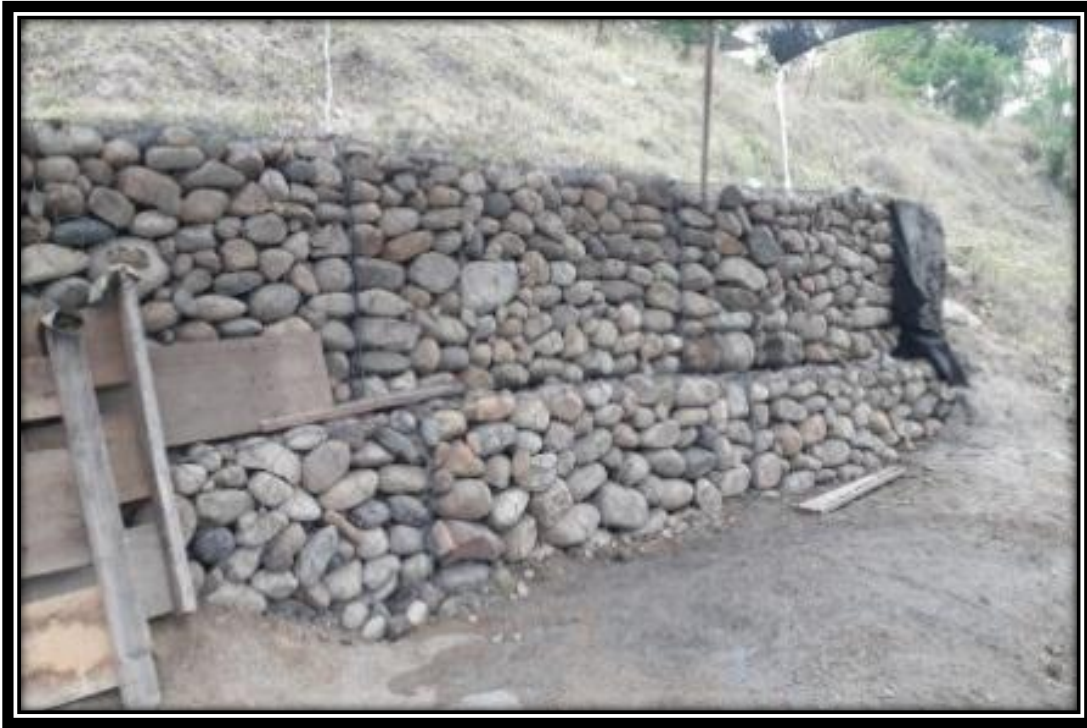
Ilustración 9. Contrato en Cundinamarca, Cáqueza, vereda Ubatoque, Supervisor Justiniano Cossio. Construcción de Gaviones.
