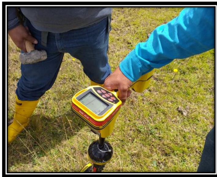
Ilustración 1. Boyacá, Combita, vereda Concepción, Justiniano Cossio. Localización de tubería
