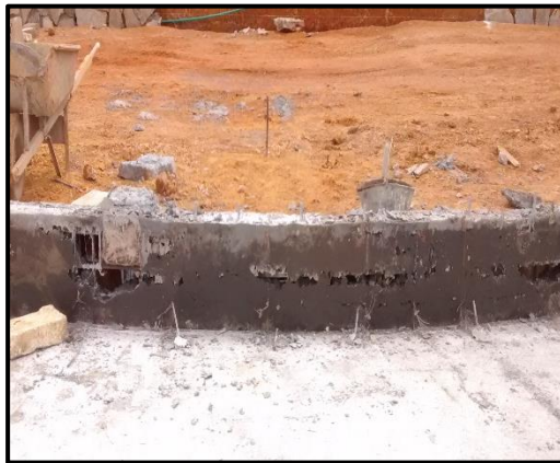
Ilustración 13 – Detalle Muro Afectado.
