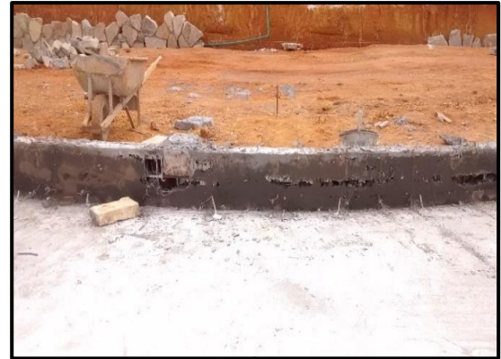
Ilustración 47 - Muro Afectado Hormiguero.
