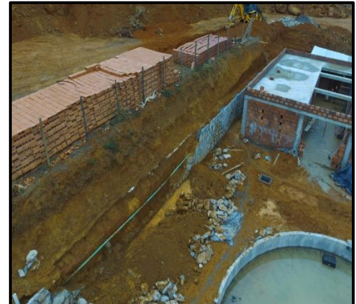
Ilustración 32 – Daño en muro de Roca.
