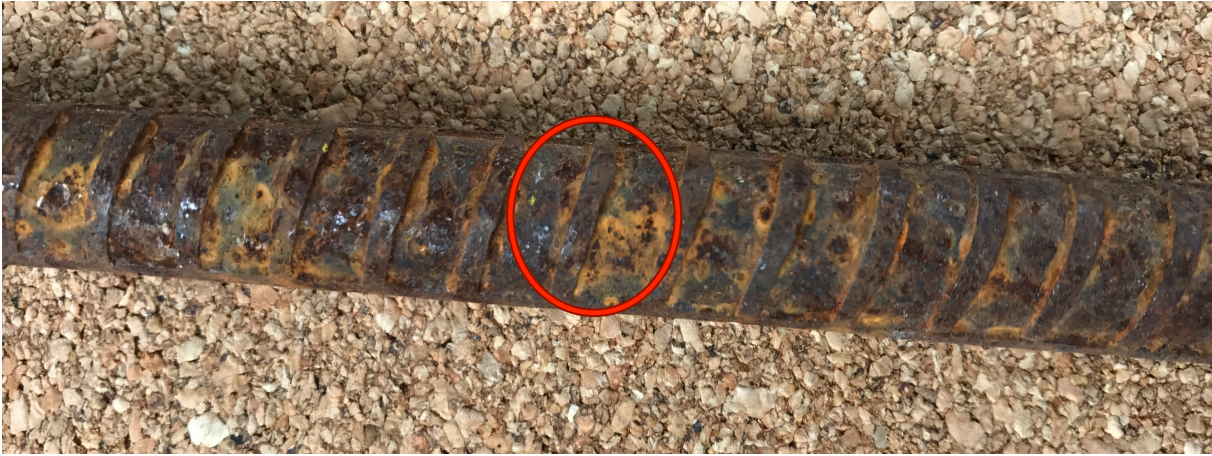
Fotografía 13. Aspecto físico que presentan algunas varillas
