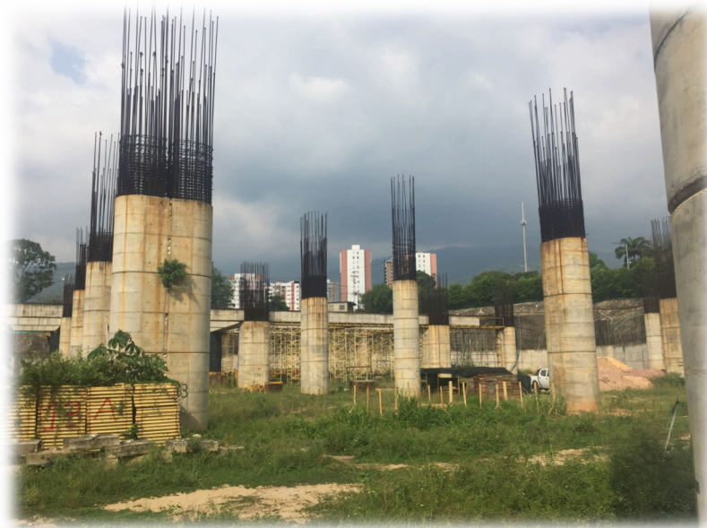
Fotografía 3. Estado visual de las columnas.
