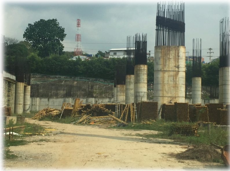
Fotografía 2. Columnas no finalizadas.
