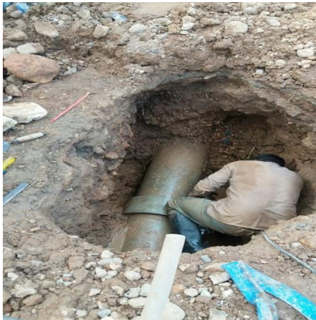
Ilustración 26. Fuga en la carrera 40 con sabanita tubo de 12"
