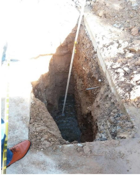
Ilustración 23. Inspección de adelantamiento de trabajos para retirar la obstrucción en la red de alcantarillado
