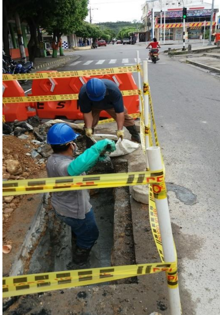
Ilustración 36. Destaponamiento de la red de alcantarillado debido a las grasa acumuladas de los restaurantes del sector de la Carrera 20 entre calles 5 y 6
