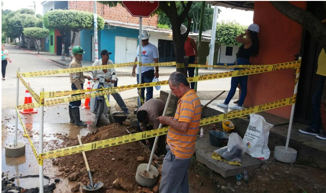
Ilustración 39 Fuga en la Carrera 36 con calle sabanita
