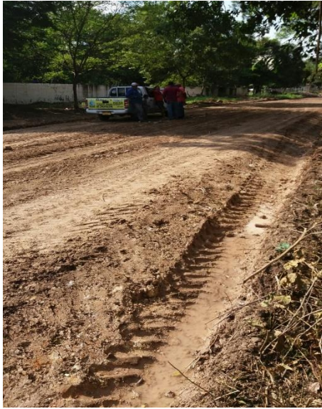
Ilustración 25. Fuga en la vía a la planta de tratamiento de agua potable, tubo de 12" en la unión universal estaban suelto los tornillos.
