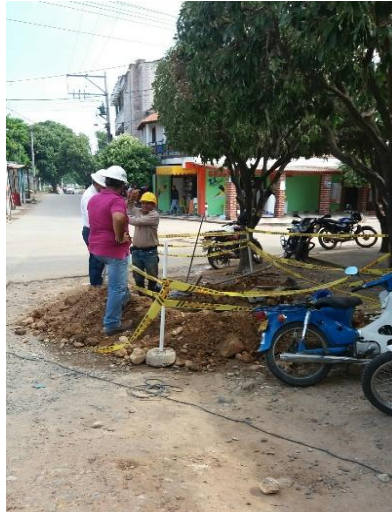
Ilustración 27. Fuga en la carrera35 con calle 1
