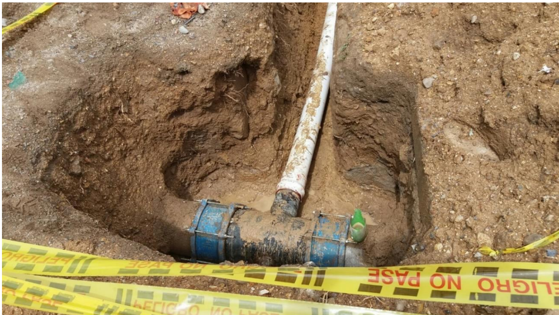
Ilustración 35. Empalme para mejorar el servicio de acueducto a los barrios Maria Eugenia alto, Cesarito y Villamare. Se le hizo reposición de tubería de 3" AC a tubería de 6" PVC
