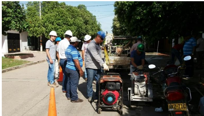
Ilustración 21. Corte, demolición y remoción de material para dar solución a una obstrucción de la red de alcantarillado, ya plenamente identificado
