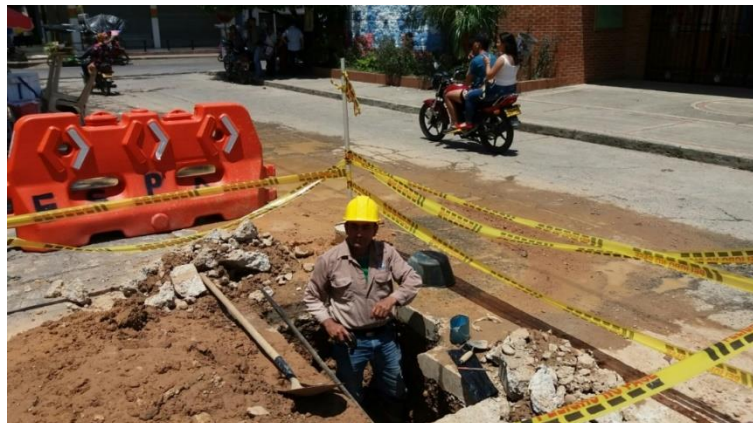
Ilustración 29. Corte de pavimento y excavación para solucionar fuga de agua potable al frente del centro de convivencia
