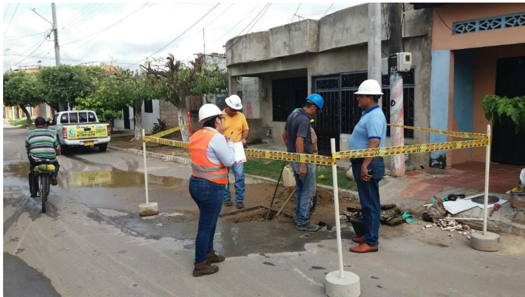
Ilustración 37. Fuga en la calle 4N con Carrera 39
