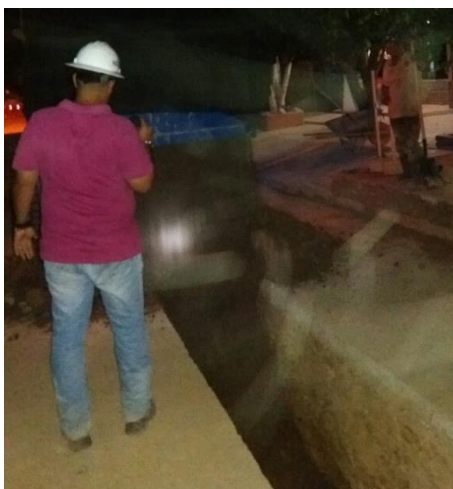
Ilustración 30. Trabajo de reposición de tubo de alcantarillado hasta las 12 de la media noche en la calle 7 entre cra 5 y 6
