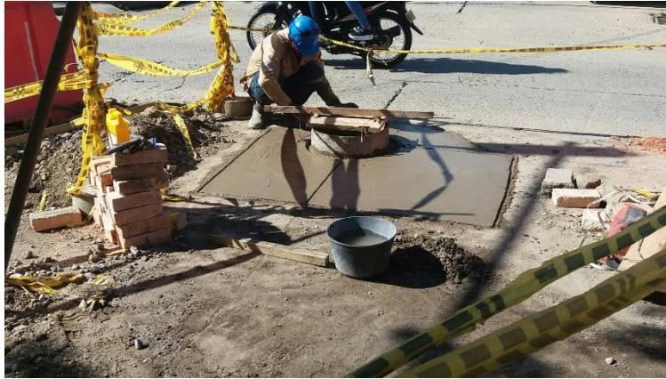
Ilustración 44 Reconstrucción de pozo de inspección y loza de concreto en la Carrera 30 con calle 3 debido al deterioro y fuga al interior del pozo, ya que esta fuga estaba socavando toda la sub-base del pavimento.
