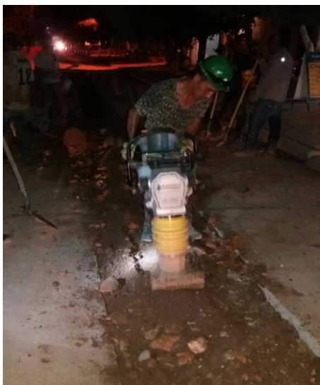
Ilustración 31. Trabajo de reposición de tubo de alcantarillado hasta las 12 de la media noche en la calle 7 entre cra 5 y 6
