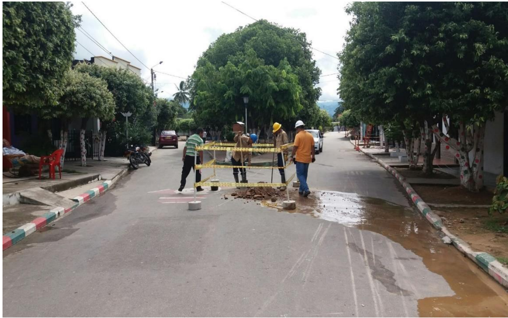
Ilustración 38 Fuga en la carrera 39 con calle 5N
