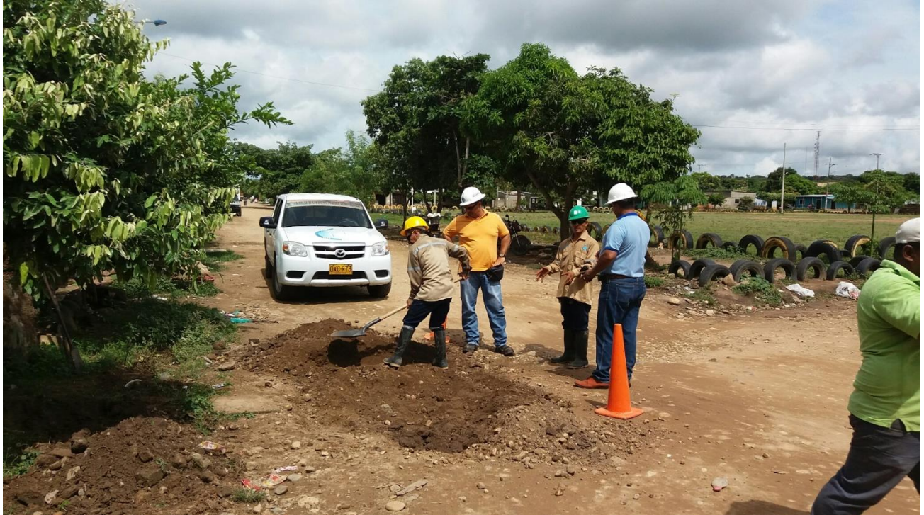
Ilustración 49 Excavación para búsqueda de válvula de cierre de 4", para la manipulación de la misma.
