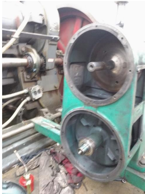
Imagen 14 Sistema de poleas del motor eléctrico
