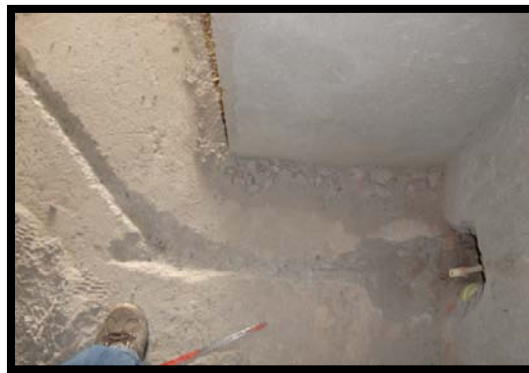
Fotos 20, Punto hidráulico de baño social sin conexión a la red
