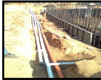
Foto 31, Tubería hidráulica y tubería sanitaria de sifones para desagüe en zona de playa de piscinas. Fuente Propia
