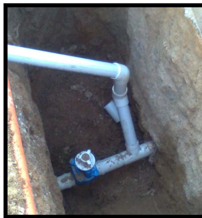
Foto 32, Válvula 2" HD para desagüe de piscina. Fuente Propia
