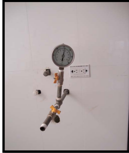
Foto 6, Manómetro y flauta para acople con la bomba. Fuente Propia
