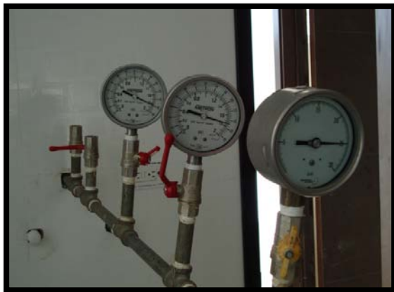
Foto 12, Manómetros para prueba de gas en calibración. Fuente Propia
