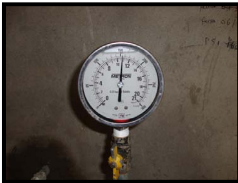
Fotos 19, Manómetro antes de iniciar medición. Fuente Propia
