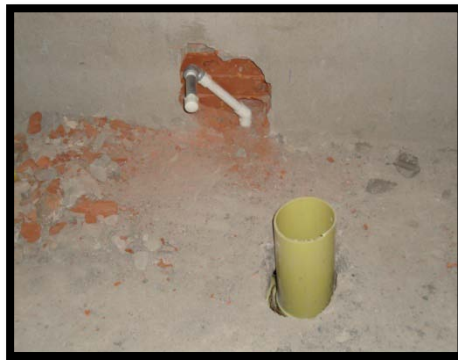
Foto 11, Punto de desagüe e hidráulico para sanitario. Fuente Propia
