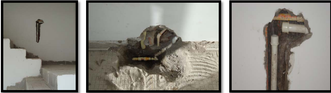
Fotos 7,8 y 9, Puntos donde se detectó fuga en la tubería hidráulica. Fuente Propia
