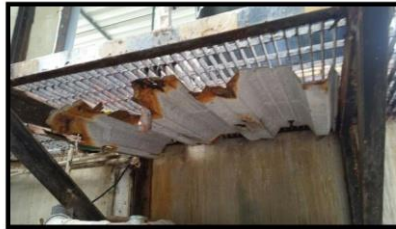
Imagen 2. Tejas bajo pasarela.
