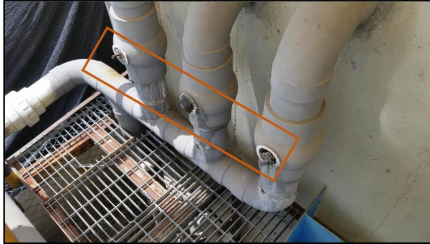
Imagen 4. Purga de extracción de lodos Averiada.
