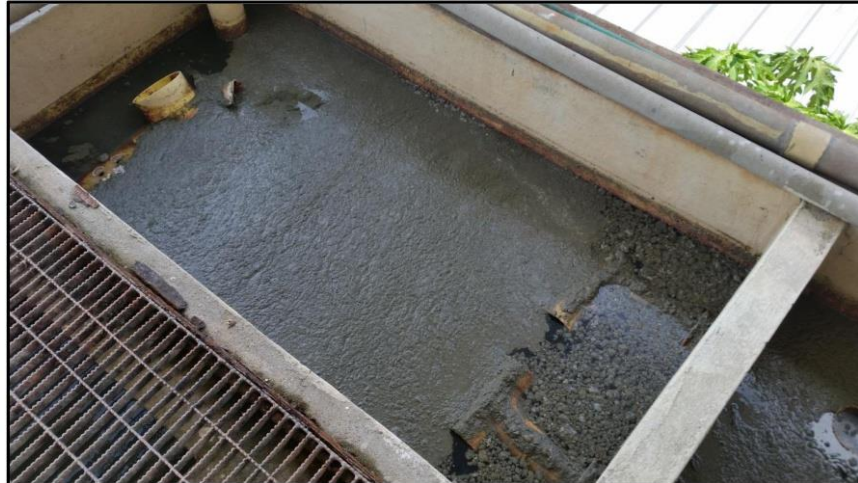
Imagen 3. Tanque # 3 Colmatado de lodos.
