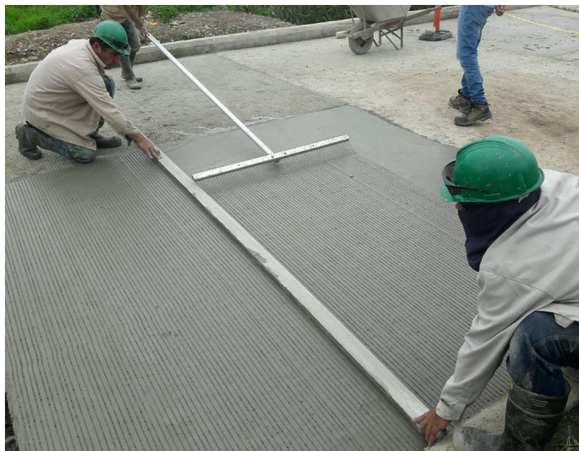
FOTOGRAFÍA 17 Rayano de la losa de concreto
