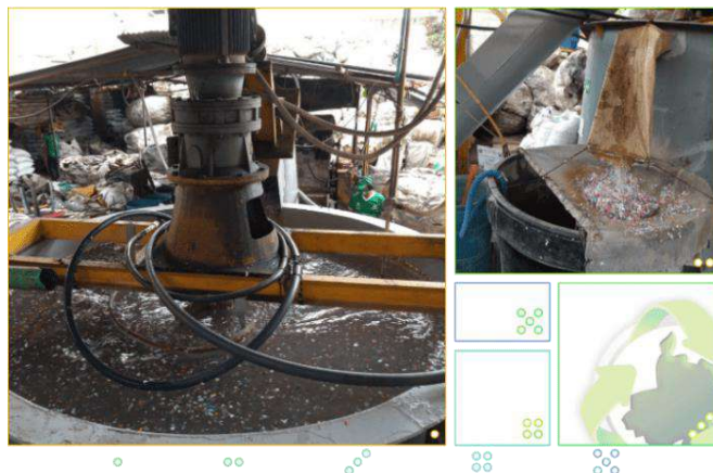
Figura 17. Unidad de separación.
