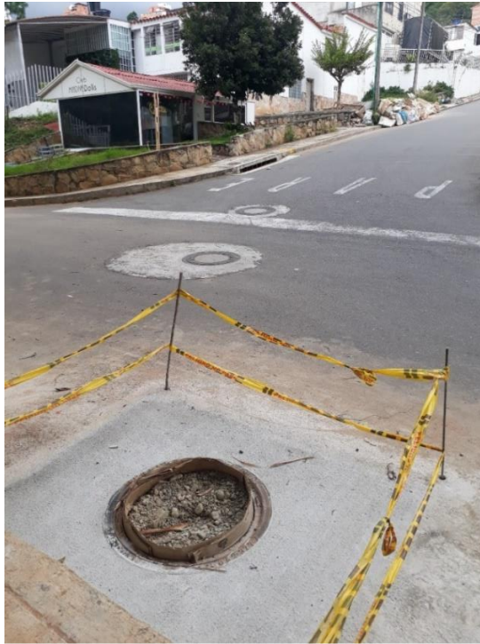
Figura 16 Cámara ampliada en el sector de Terrazas, para alojar los equipos ópticos
