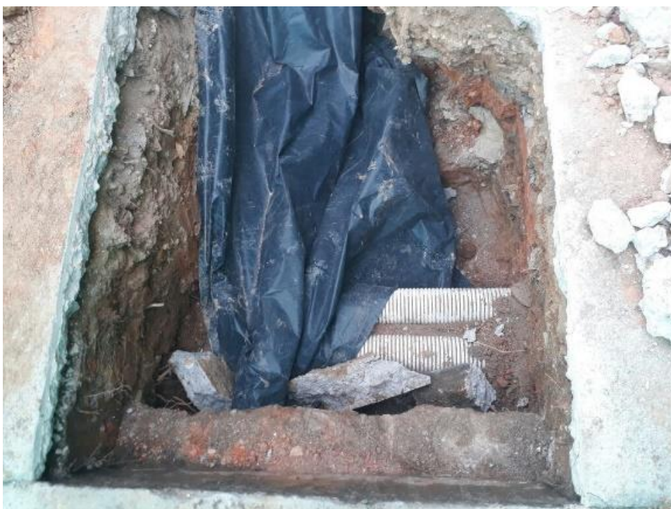
Figura 23 Ductería que debe ser trasladada para empalmar con nueva canalización del AFO
