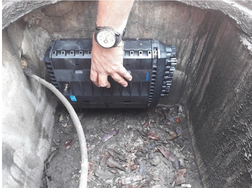
Figura 14 Cámara tipo D necesario reformar a una tipo F, ya que los elementos ópticos no tienen suficiente espacio para ser adosados y que la fibra se aloje sin sufrir estrés
