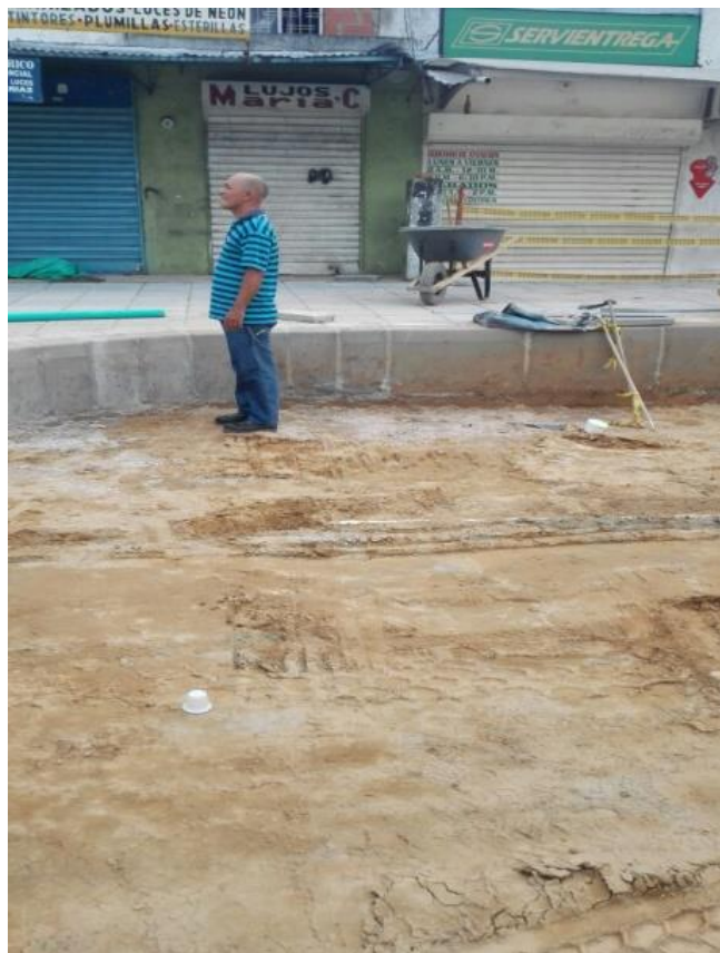
Figura 20 Profundización de la ductería en el sector del Rincón de Girón por obras de Metrolínea FUENTE: Autor
