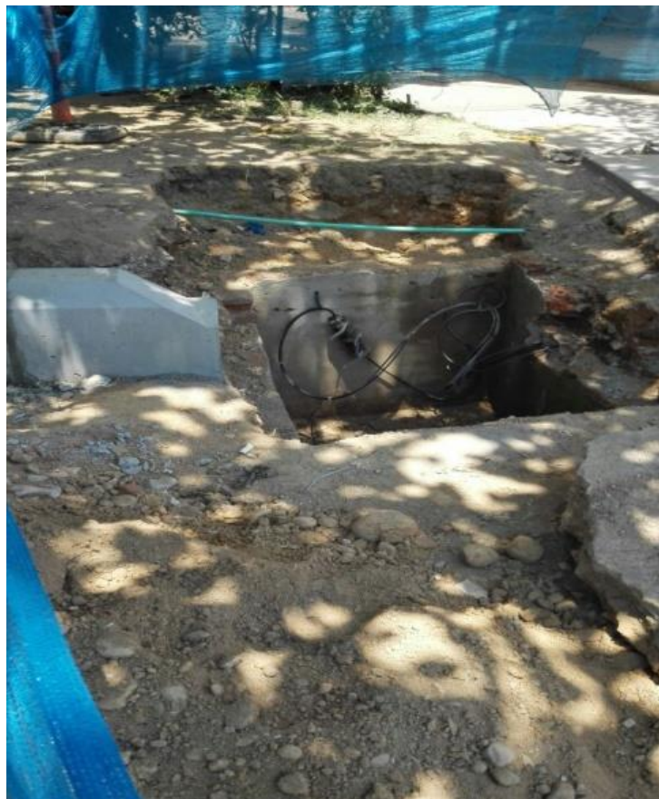
Figura 19 Cámara encontrada en sardinel necesario reubicar a zona verde o andén
