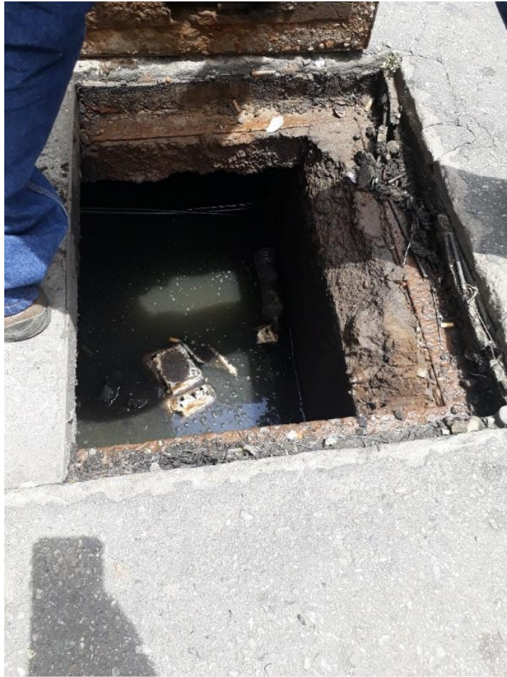
Figura 27 Estado de canalización en sector Centro: Cámara inundada con aguas negras. (CII 34 con Cra 18) FUENTE: Autor
