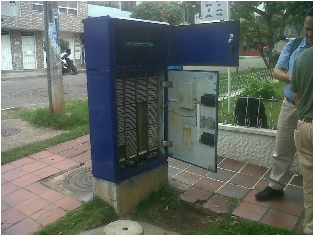
Figura 5 Gabinete Óptico (GO) instalado sobre armario KRONNE. Calle 20 #31-98 Barrio San Alonso. FUENTE: Autor
