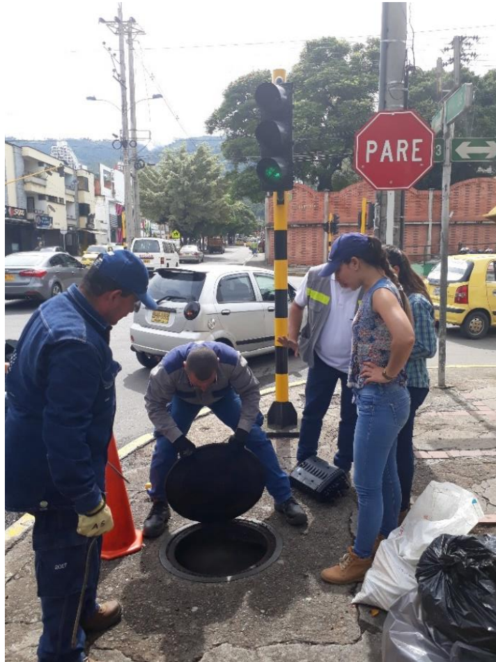
Figura 26 Inventario de canalización en el sector de Cabecera (Cll 56 con Cra 33) FUENTE: Autor
