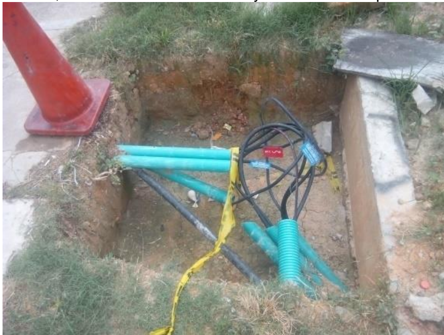
Figura 12 Cámara a reubicar por mal diseño FUENTE: Autor
