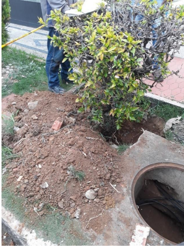
Figura 15 Cámara en Av. González Valencia con 45 necesario ampliar y recuperar canalización por obstrucción FUENTE: Autor
