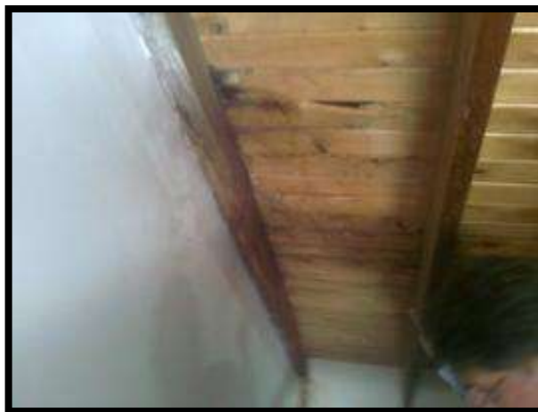
Foto 50. Evidencia De Los Daños Causados Dentro Del Apartamento
