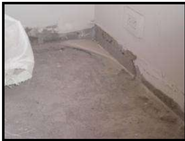
Foto 42. Evidencia De Inadecuada Instalación.
