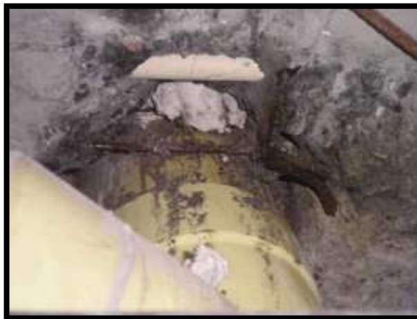
Foto 13. Tubería De 3/4" Aa No Conectada.
