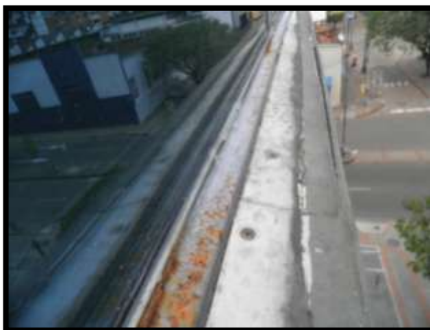
Foto 114. Vista De Cómo Se Encontraba La Alfajía.
