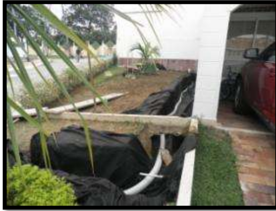
Foto 91. 20m De Longitud De Filtro.
