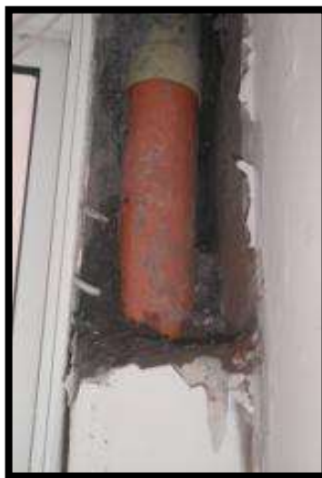
Foto 6. Bajante Perforado En Puerta Ventana De Balcón.
