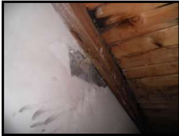
Foto 52. Detalle De Los Daños Causados En La Cubierta.
