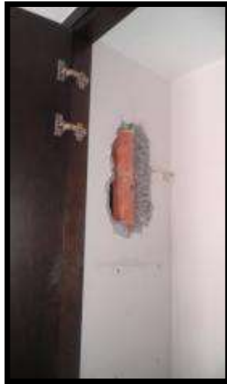
Foto 7. Bajante Perforado En Closet Lateral De Habitación Principal.
