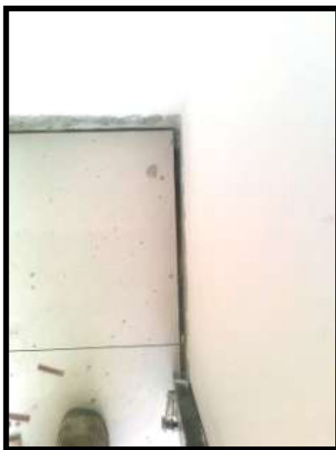
Foto 45. Separación Entre Los Muros Y La Losa.
