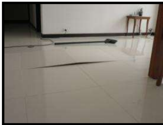
Foto 38. Evidencia De Levantamiento De Piso En Sala.
