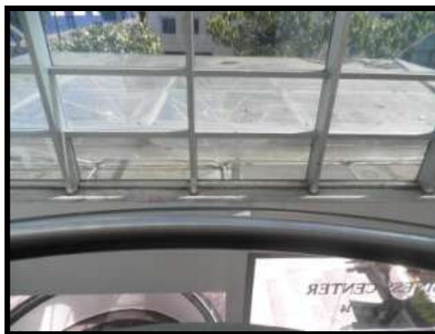
Foto 104. Figa Falsa En Superboard De Fachada Parte Baja Manchada Por La Humedad.
