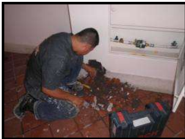
Foto 13. Fuga De Agua En Zonas Comunes
