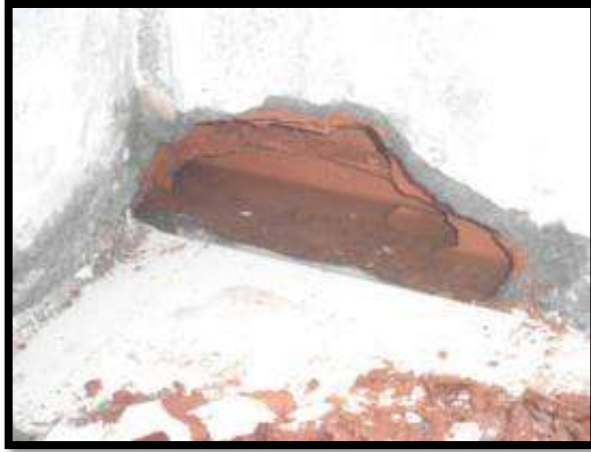
Foto 94. Emposamiento De Agua Dentro De La Mampostería.
