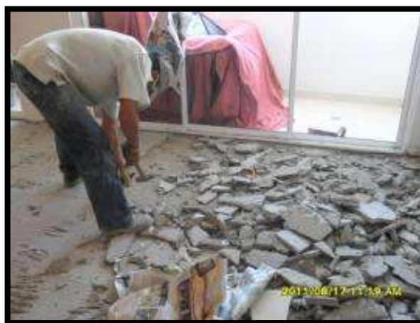
Foto 41. Escombros Por Causa Del Levantamiento.
