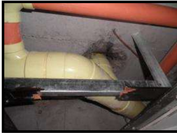
Foto 12. Punto Sanitario De 4"
