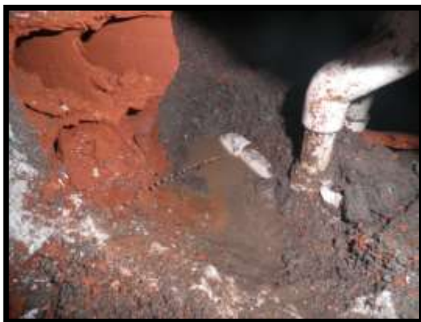
Foto 14. Unión De Accesorios Con Escape De Agua.
