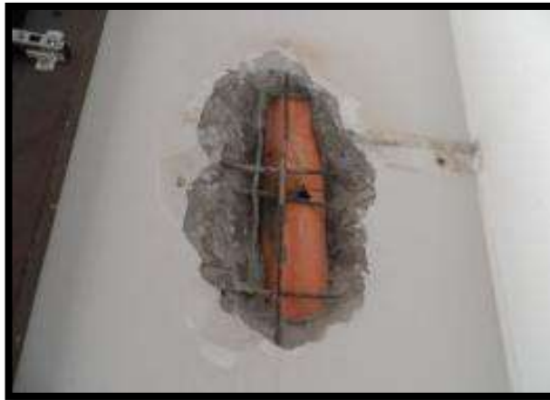
Foto 8. Bajante Perforado En Closet De Habitación Auxiliar.
