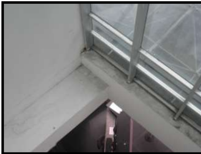
Foto 102. Humedad En Viga Interna De Fachada.
