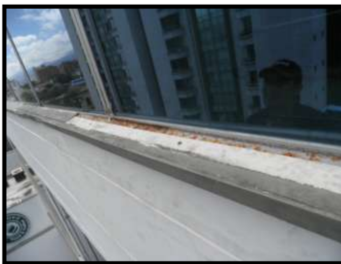
Foto 112. Detalles De Las Condiciones En Las Que Estaba La Alfajía.
