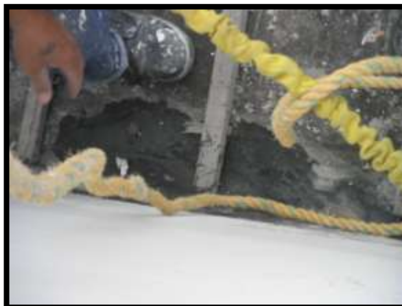
Foto 51. Presencia De La Humedad Sobre La Cubierta.
