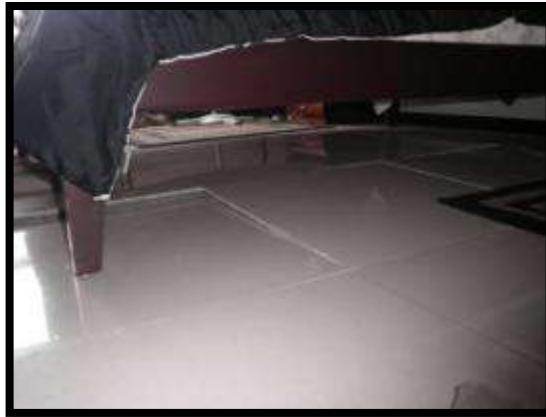
Foto 37. Evidencia Del Levantamiento De Piso En Habitaciones.
