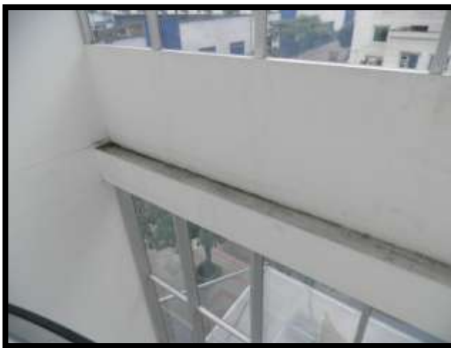
Foto 105. Recubrimiento De Viga Metálica En Superboard De Fachada Parte Alta Manchada Por Humedad.
