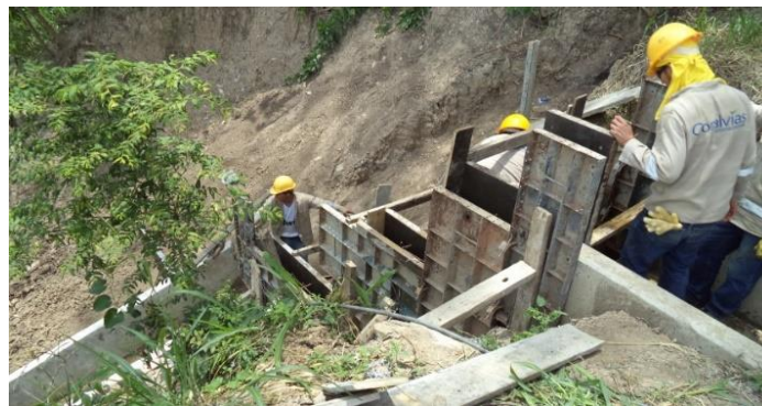
Imagen 7 Canal interceptor depósito 5 Lisboa
