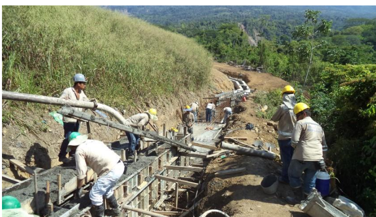
Imagen 21 Fundida de módulo de canal disipador
