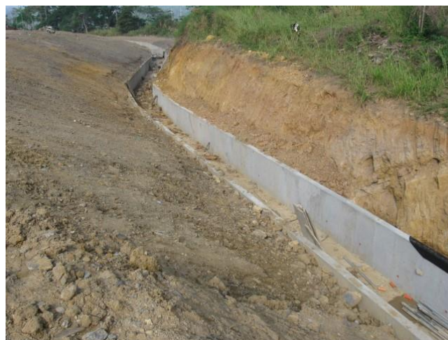
Imagen 6 Canal interceptor depósito 2 Lisboa
