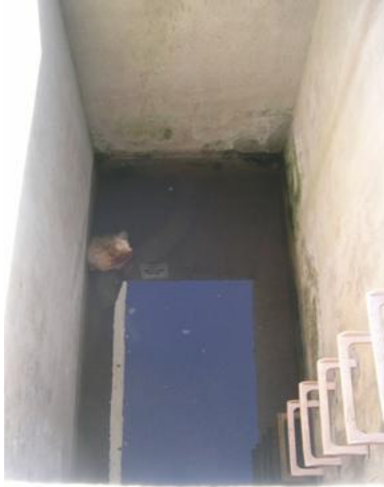
FIGURA 34. Nivel de agua inicial en la arqueta final de salida.
