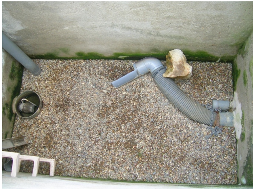
FIGURA 35. Nivel de agua final en la arqueta de salida.
