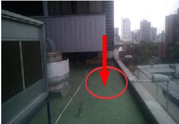
Imagen 6. Sitio de instalación del tanque
