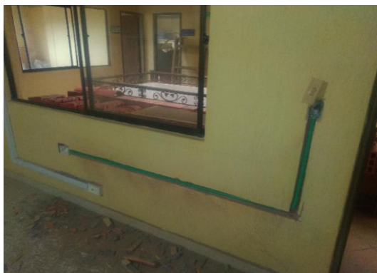
Figura 8 Suministro de toma 20 a 110v
