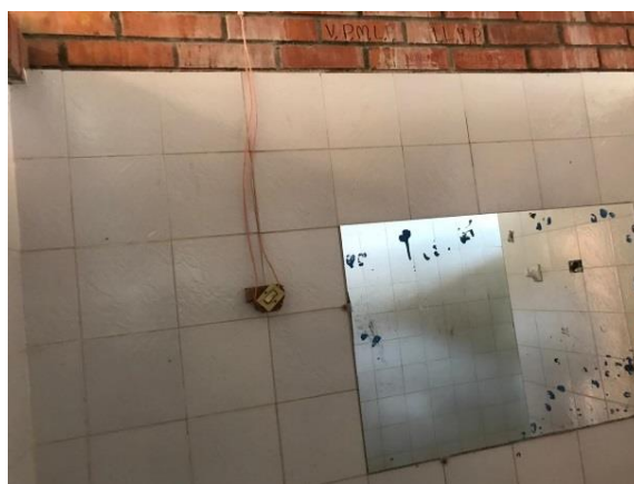
Figura 41 Instalaciones eléctricas Colegio Técnico Agropecuario
