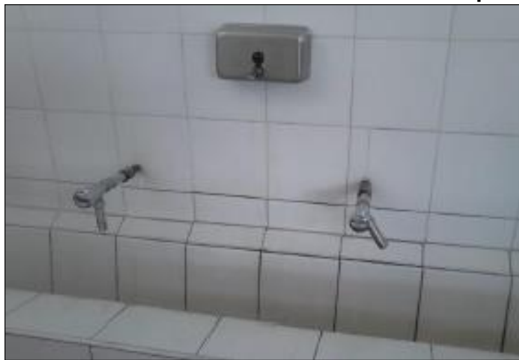
Figura 11. Llaves ahorradoras instaladas en el baño 1 de planta.
