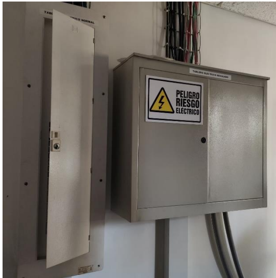
Figura 12. Tableros eléctricos Fuente: El autor. 2020
