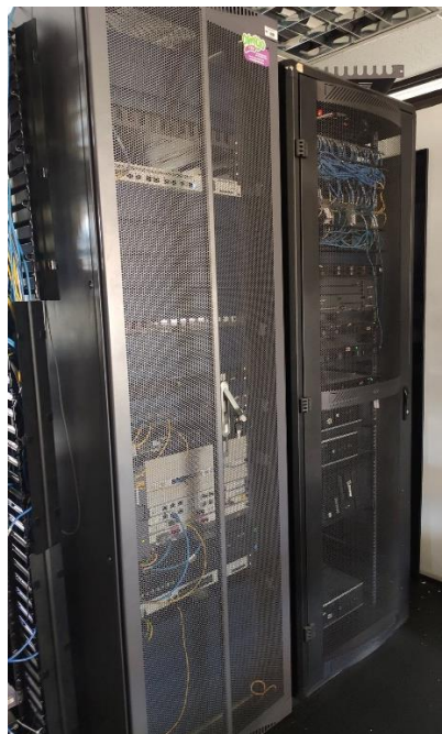
Figura 11. Equipos rack 2 y 3 Fuente: El autor. 2020
