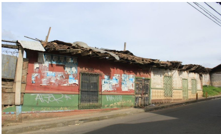
Fotografía N° 20 Deterioro y desaparición de un gran número de edificaciones ubicadas en bordes del perímetro del Centro Histórico.
