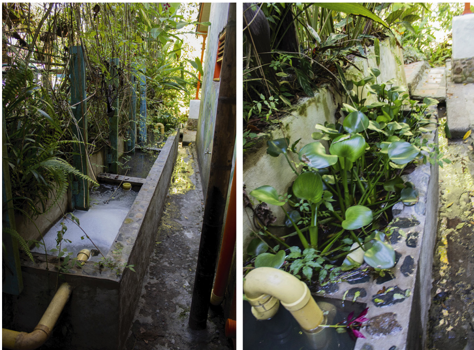
Figura 6-9. Biofiltro purificador de aguas residuales.
