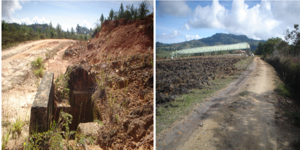
Foto 109-Foto 110 Verificación funcionamiento de alcantarillas y Ausencia de cunetas
