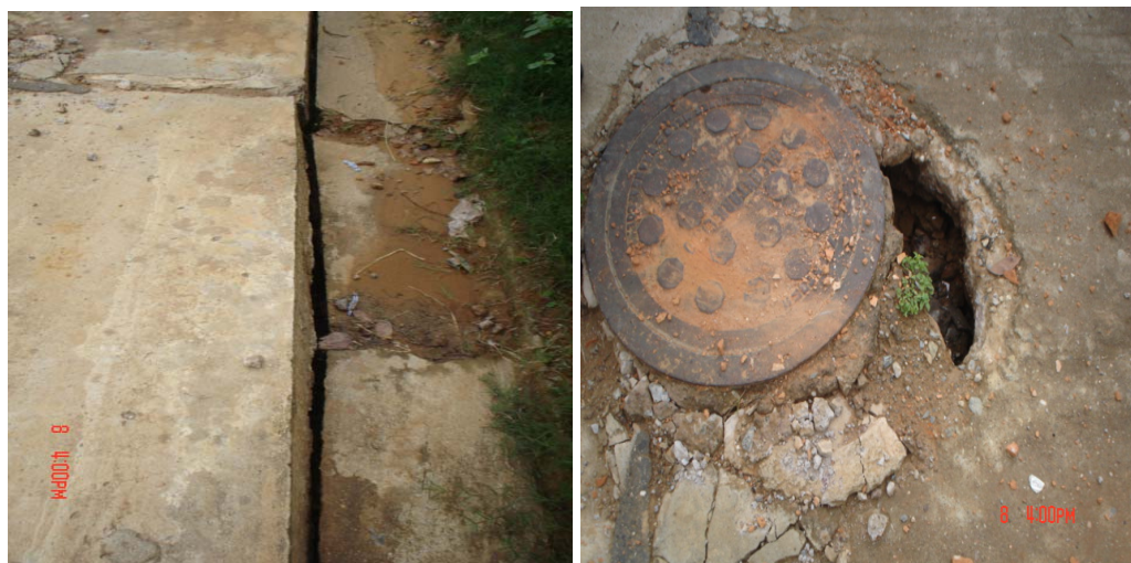
Foto 88-Foto 89 Registro del pavimento fracturado pozo colector deteriorado
