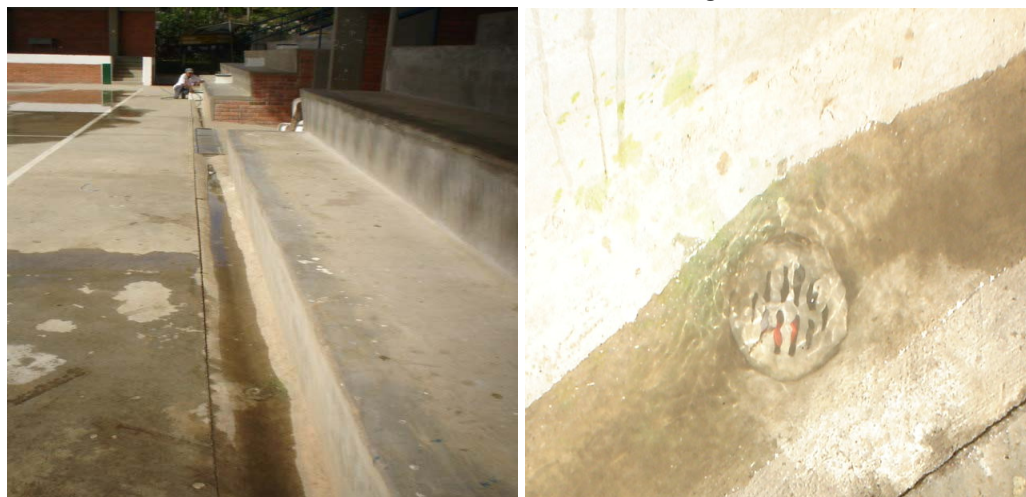
Foto 11-Foto 12 Revisión del daño en la tubería de conducción de aguas lluvias
