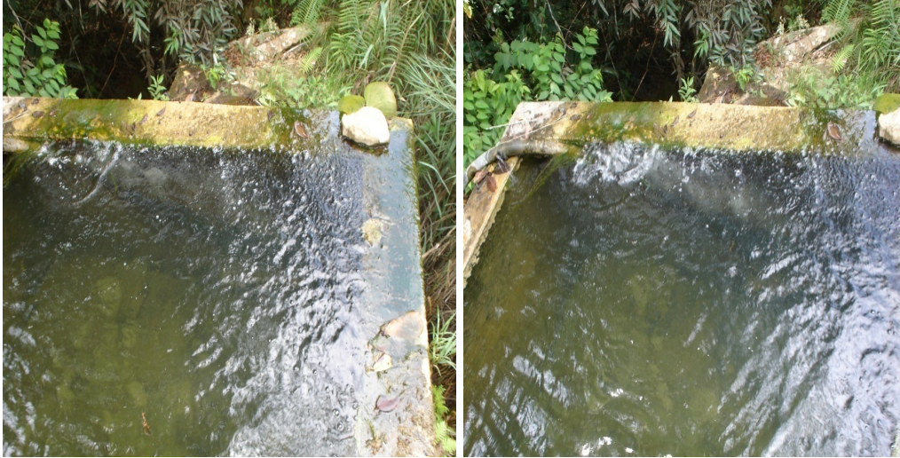
Foto 70-Foto 71 Primer tanque de almacenamiento
