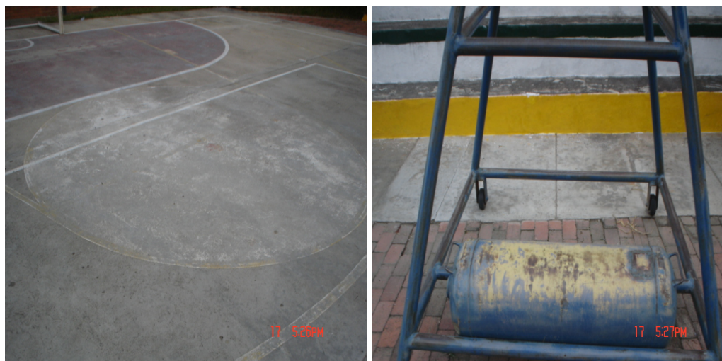
Foto 13-Foto 14 Revisión del mal estado del coliseo falta demarcación de canchas y pintura en los arcos.
