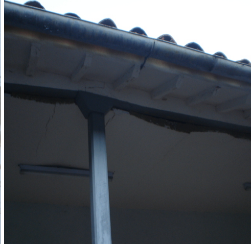
Techo a punto de colapsar
