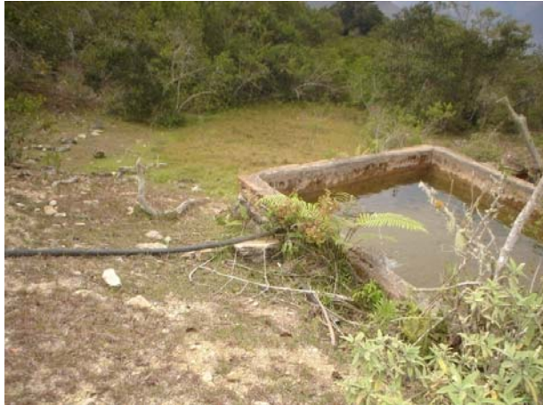
Foto 75 Tercer y ultimo tanque de almacenamiento, también permanece lleno.
