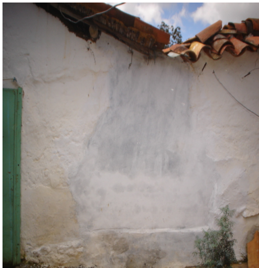
Foto 126 Pared arreglada debidamente
