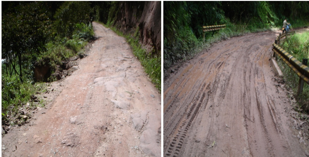
Foto 111-Foto 112 Registro fotográfico del mal estado de la vía
