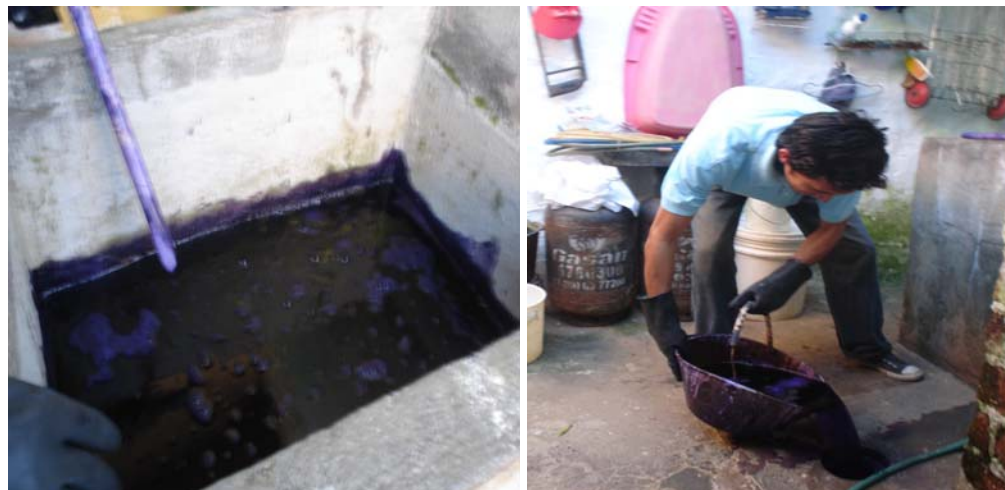
Foto 133-Foto 134 Pruebas con anilina para encontrar la tubería que causa la humedad
