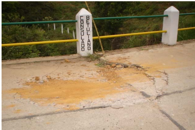
Foto 31 Verificación del daño en el puente sobre la quebrada Uchuval
