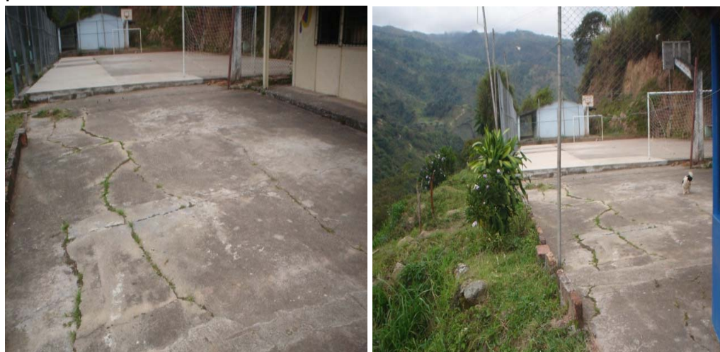
Foto 27-Foto 28 Visita inicial donde se verificó el deterioro del patio y la ausencia del muro preventivo
