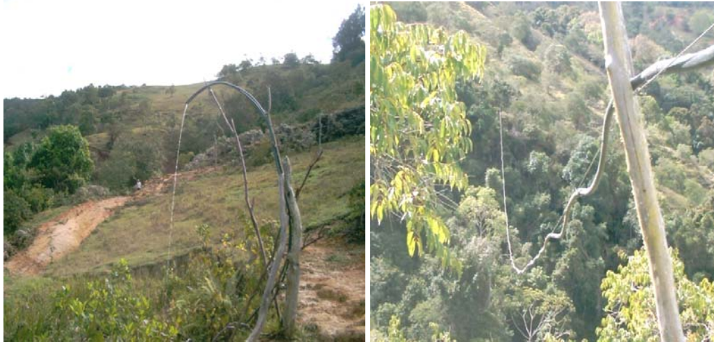
Foto 65-Foto 66 Instalación en la casa de Luis Granados
