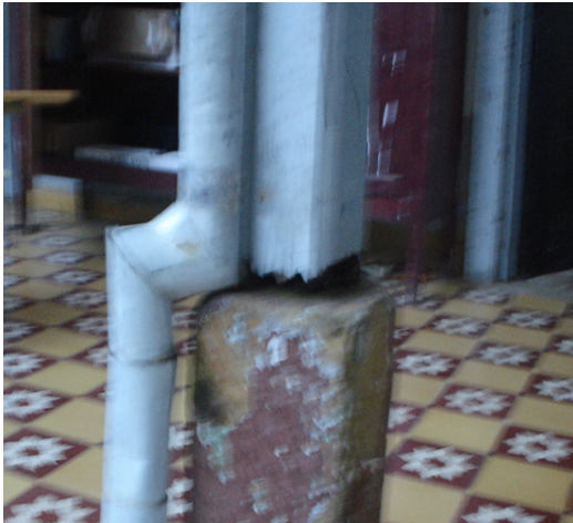
Foto 130 Columnas deterioradas a punto de colapsar
