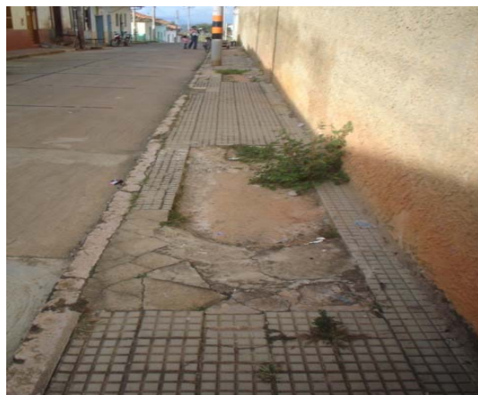
Foto 95-Foto 96 Estado de deterioro del andén
