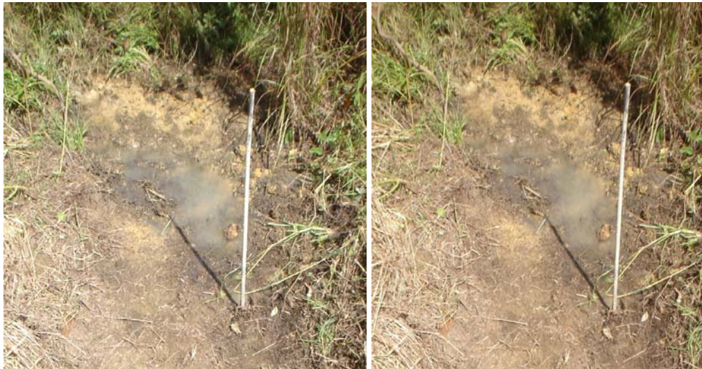
Foto 82-Foto 83 Vista del pozo séptico que permanece lleno y con presencia de zancudos
