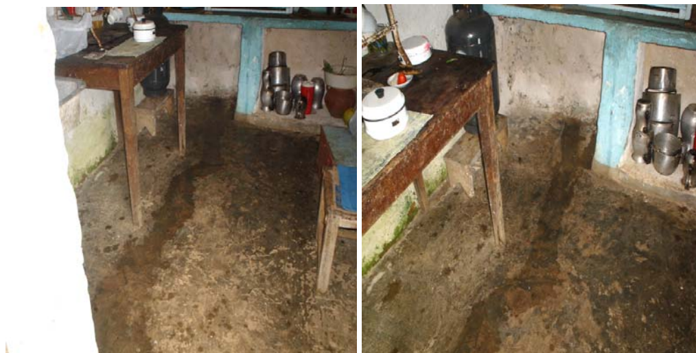
Foto 131-Foto 132 Visita donde se verifico la humedad se presentan malos olores
