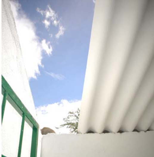
Foto 10 Problema ocasionado por la brisa, la teja no estaba amarrada debidamente.
