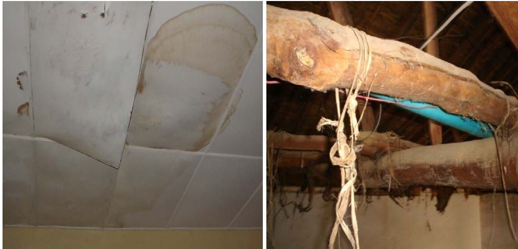
Foto 3-Foto 4 Problemas ocasionados por la lluvia, cielorraso manchado y sucio
