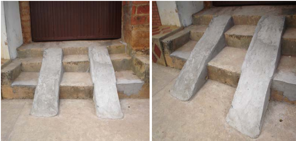
Foto 116- Foto 117 Invasión de vía por parte de la rampa-Invasión de vía aproximadamente 50 cm
