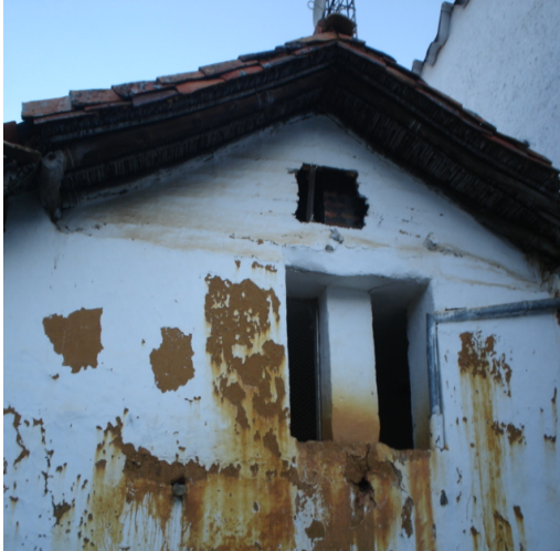
Foto 128 -Foto 129 Paredes en mal estado
