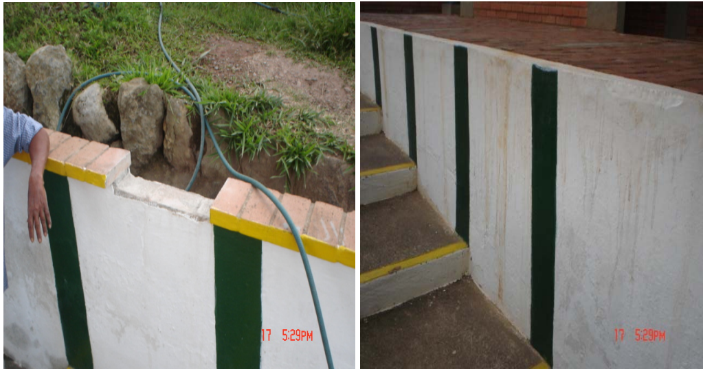
Foto 15-Foto 16 Detalles por arreglar y paredes manchadas falta pintura.
