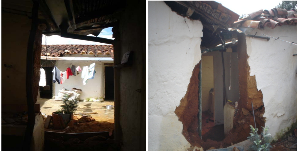
Foto 124-Foto 125 Visita a las viviendas donde se presentó el colapso del muro divisorio
