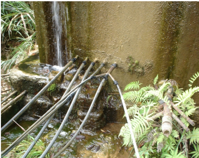
Foto 72 Mangueras de los usuarios que salen del tanque de almacenamiento
