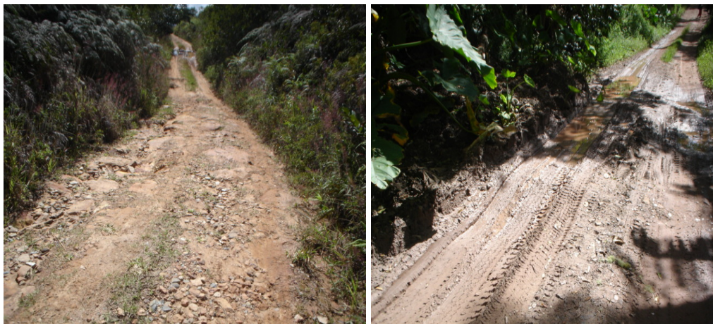
Foto 107-Foto 108 Vía a la Vereda la Guayana se verifica el estado de deterioro de la vía
