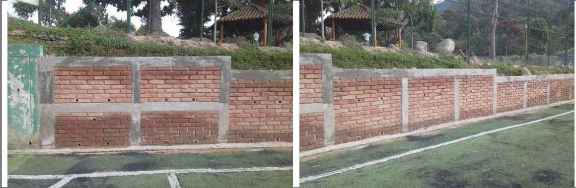
Muro en ladrillo temosa a la vista con lloraderas en cada sección de 2m de largo.
