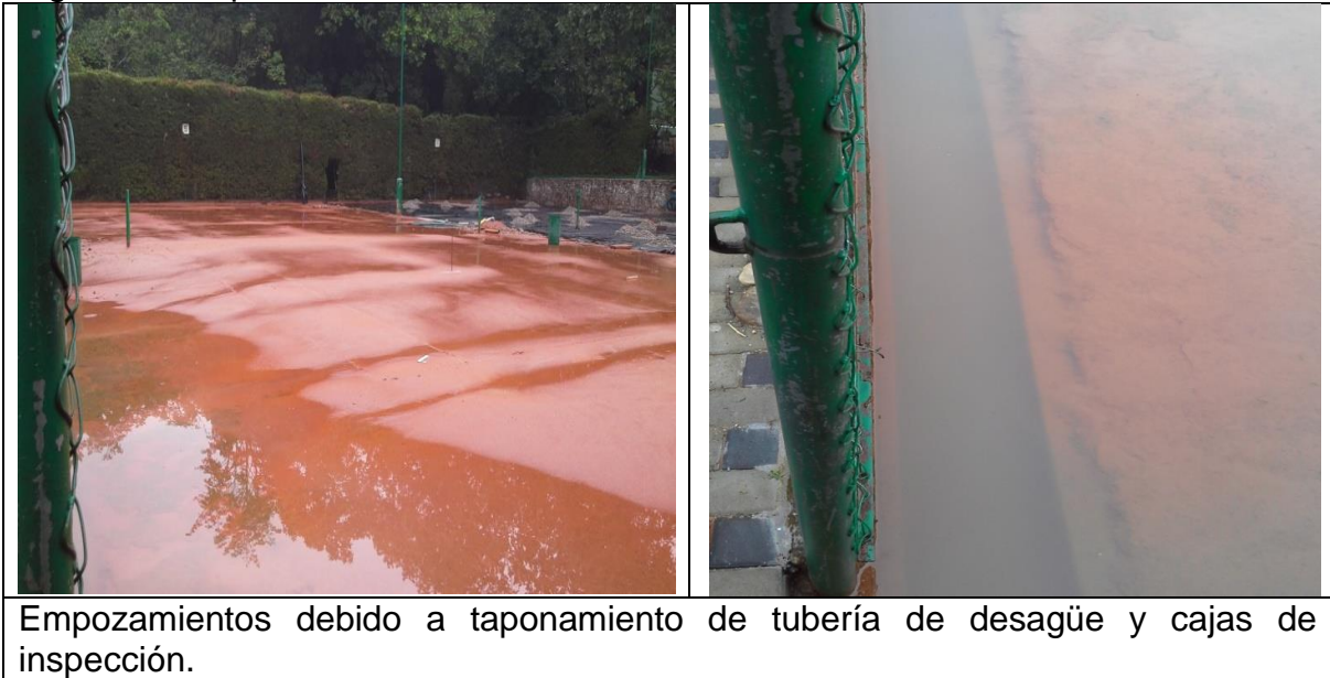
Figura 28 Empozamiento en cancha
