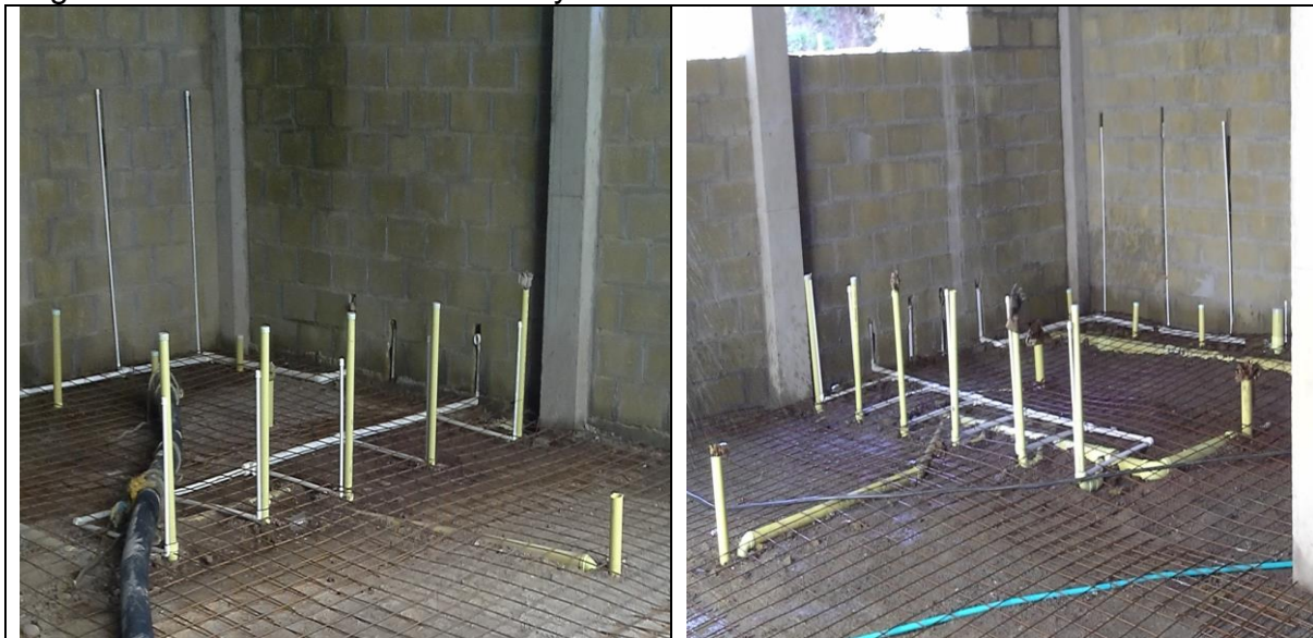
Instalaciones hidráulicas y sanitarias.
