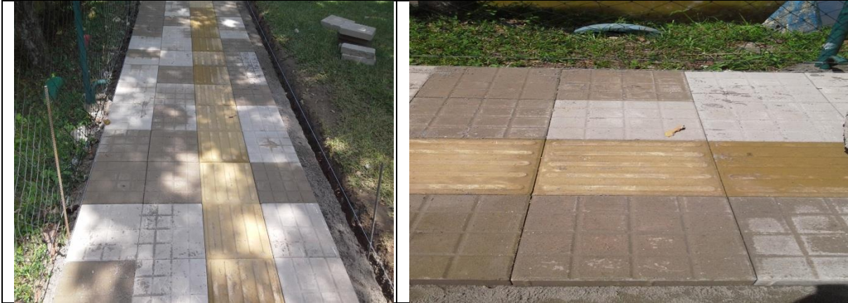
Losa de espacio público asentadas sobre arena.
