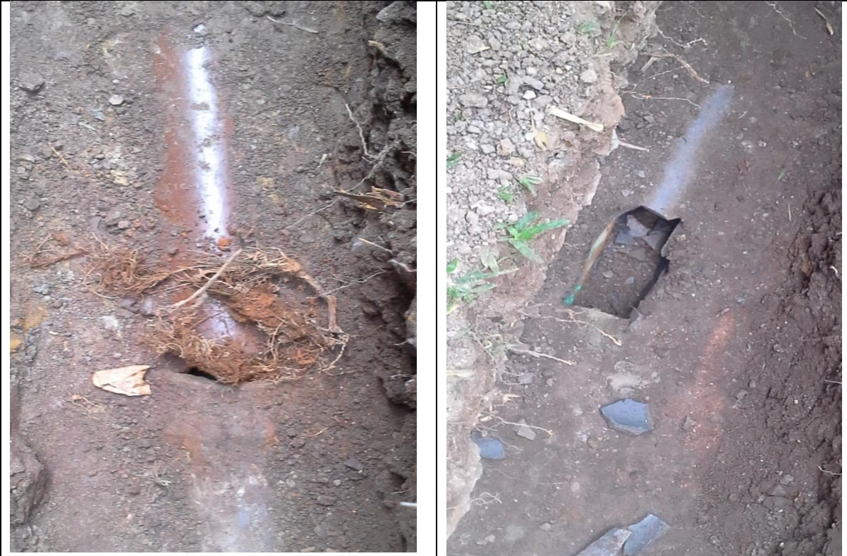
Figura 29 Tubería desagüe partida
