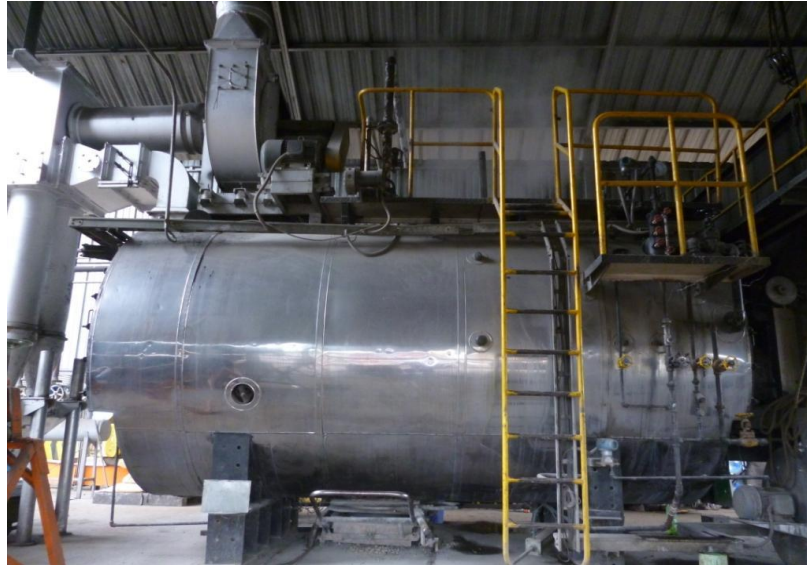
Figura 11. Caldera pirotubular de 200 BHP.
