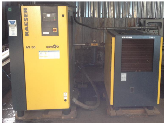
Figura 13. Compresor de tornillo y secador refrigerativo KAESER Fuente: Autor
