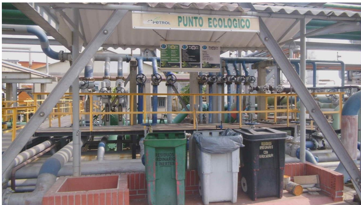
Imagen 1. Punto Ecológico del Cuarto de Control de Supervisores.
