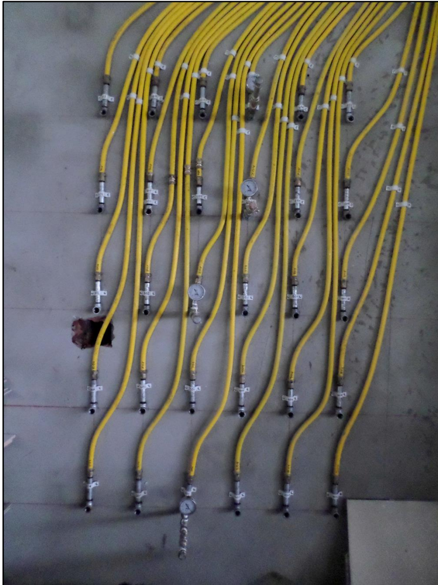
Imagen 25. centro de medicion para la red de gas en torre 1.
