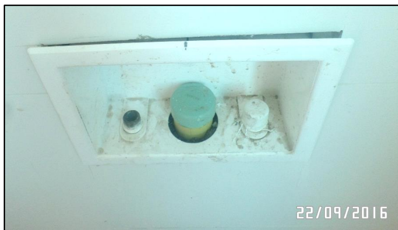
Imagen 31. Punto hidráulico de la lavadora.
