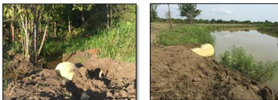
Figura 23. Tubería de drenaje.
