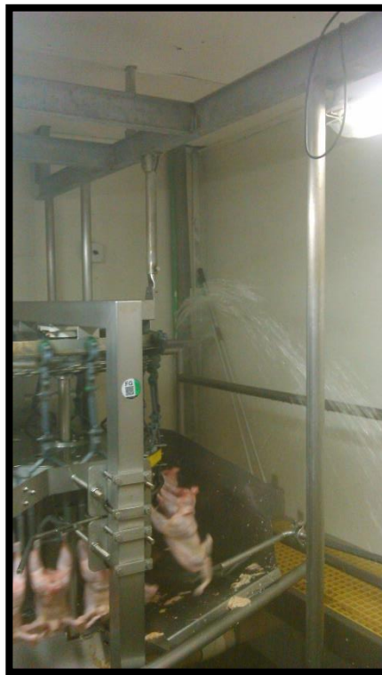
Imagen 3. Rotura tubería área Water Chiller .
