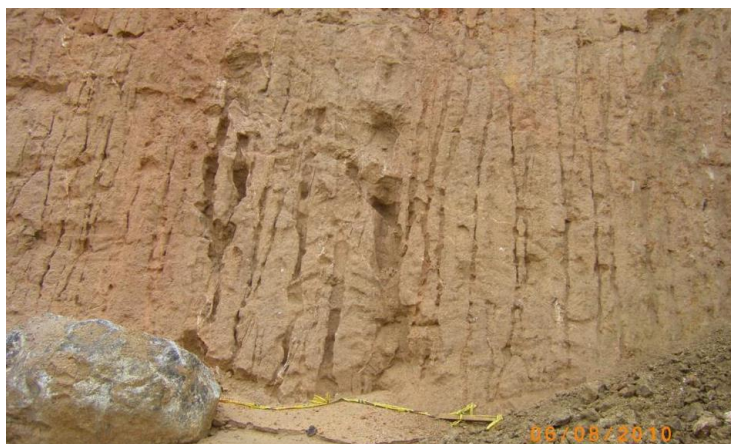
Imagen 23: Erosión en Taludes.
