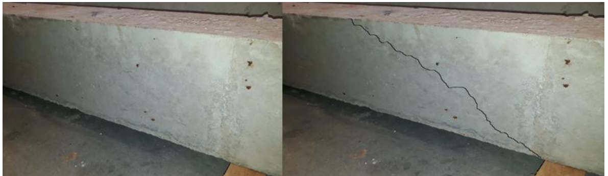
Figura 16. Falla a cortante presente en un elemento de concreto reforzado.
