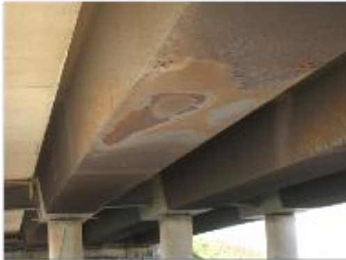
Figura 3. Parte inferior de un paso elevado de Acero para intemperie corroído. (Damgaard et al., 2010)
