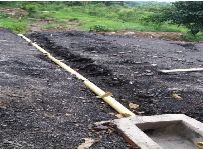
Ilustración 23: desagüe de unidad sanitaria
