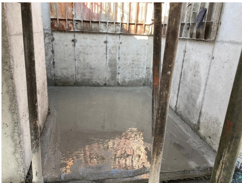
Figura 10. Fundida tapa protectora foso ascensor 1 piso 19
