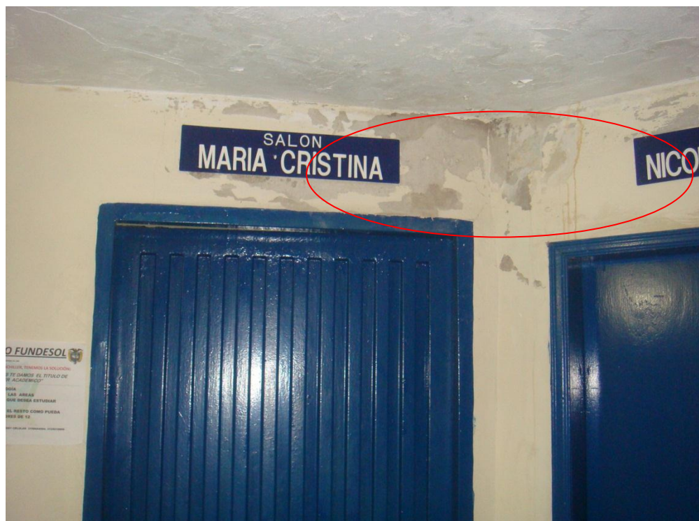
Humedad en paredes.
