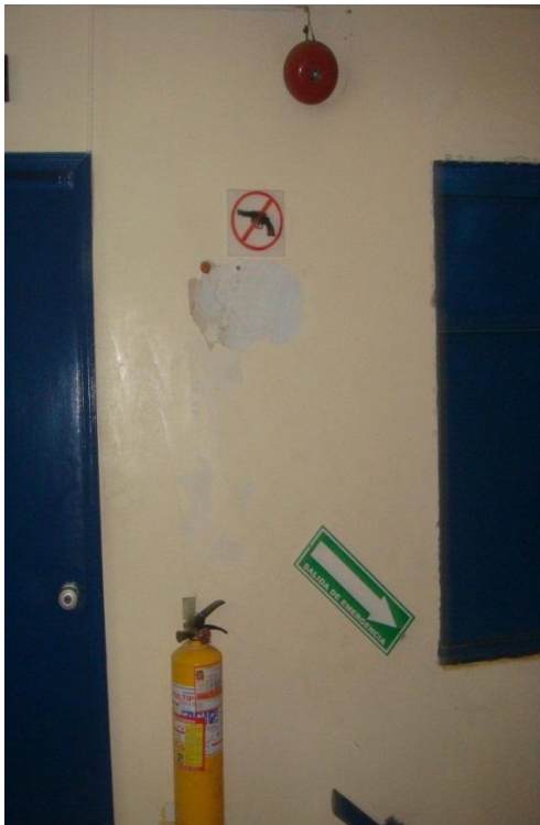
Extintor en mala Ubicación
