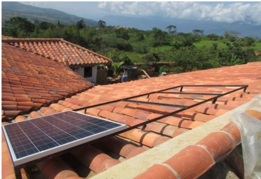
Figura 28. Estructura soporte de paneles solares
