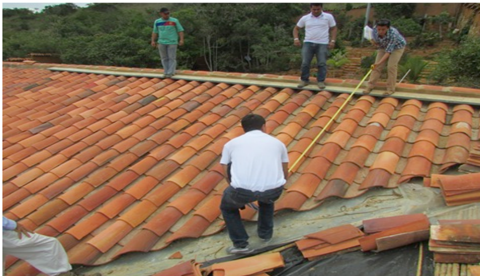
Figura 43. Tejado donde se instaló el banco de paneles
