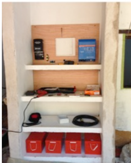
Figura 41. Inversor, regulador, baterías, monitores.
