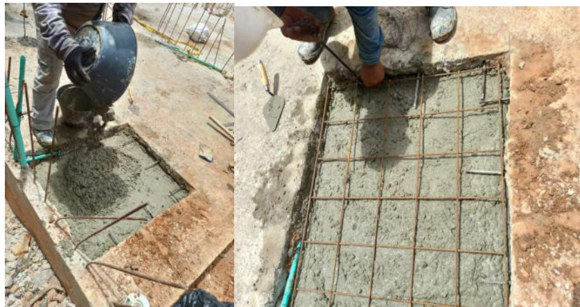
Figura 30. Fundida de la primera capa del sobre cimiento con colocación de malla
