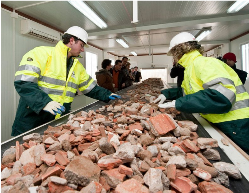
figura 4 : desechos de construcción y demolición.
