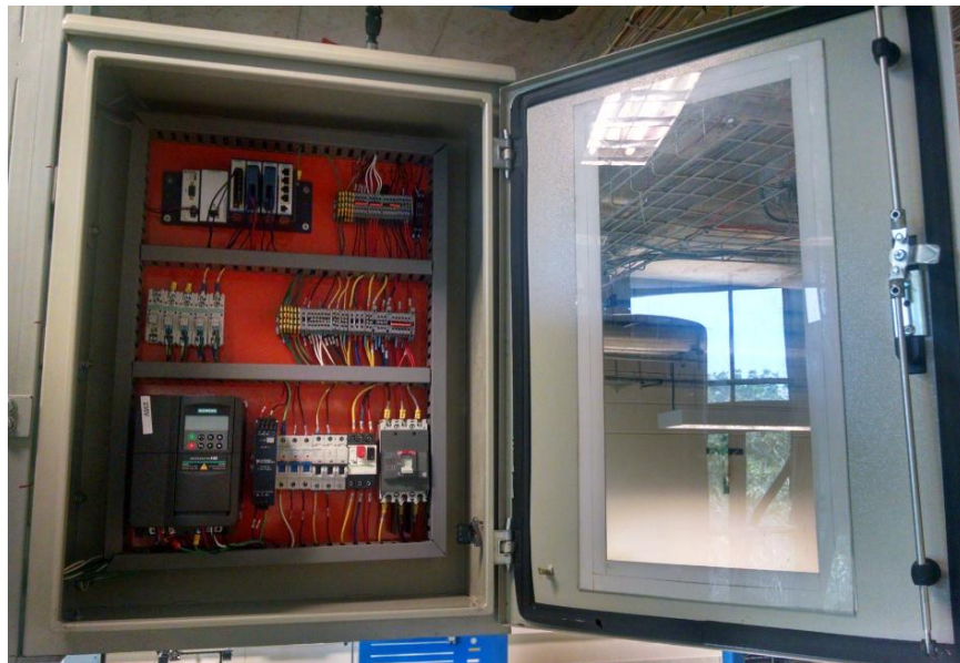
FIGURA 3-1. TABLERO DE CONTROL Y POTENCIA
