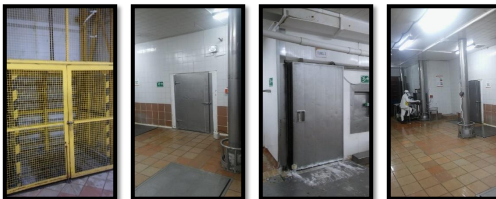
Imagen 6. Fotografías de muelles y el ascensor para transportar producto de los túneles del segundo piso hacia el primer piso, para la cámara de conserva de congelado y refrigerado.
