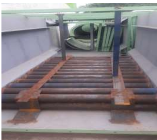
Figura 75. Parte interna de una de las secciones con paletas de arrastre y barredoras.
