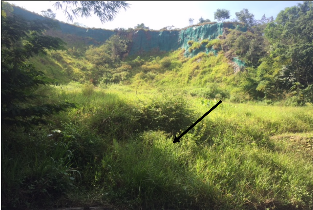
Fotografía 1-2 : Crecimiento excesivo de malezas en muro en gavión sector Las Colinas
