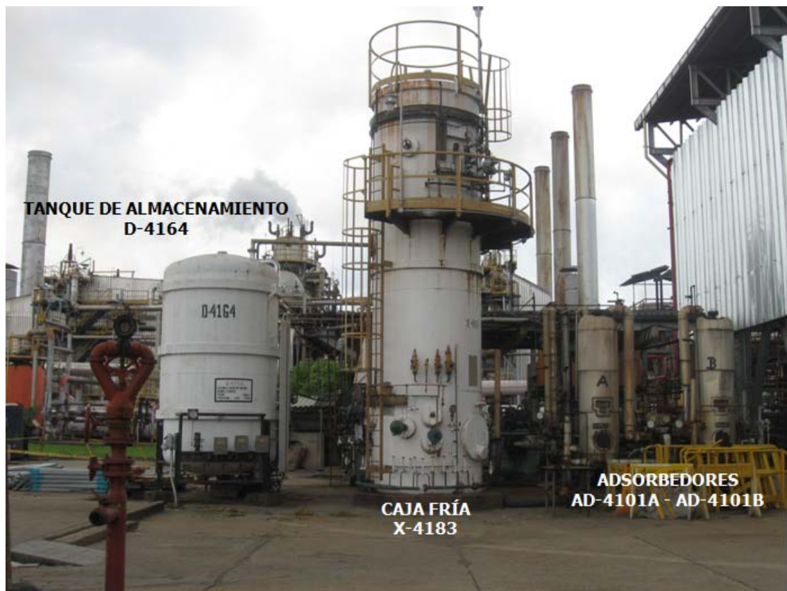
Figura 2. Vista general de la planta generadora de Nitrógeno Líquido [1]
