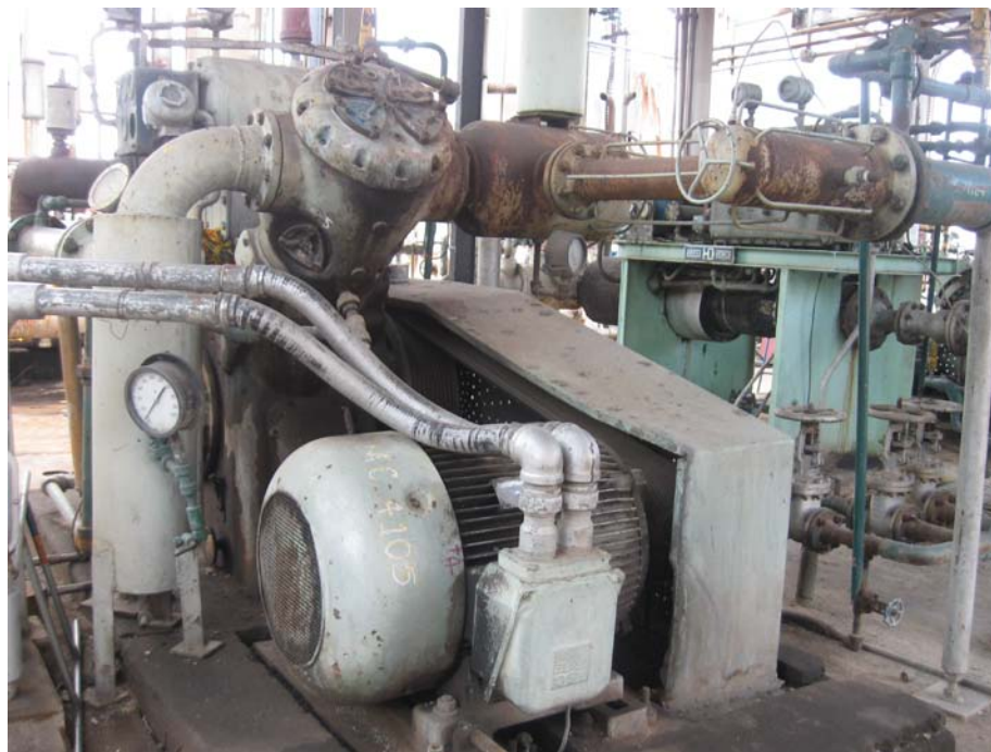
Figura 7. Compresor de aire C-4105 [1]
