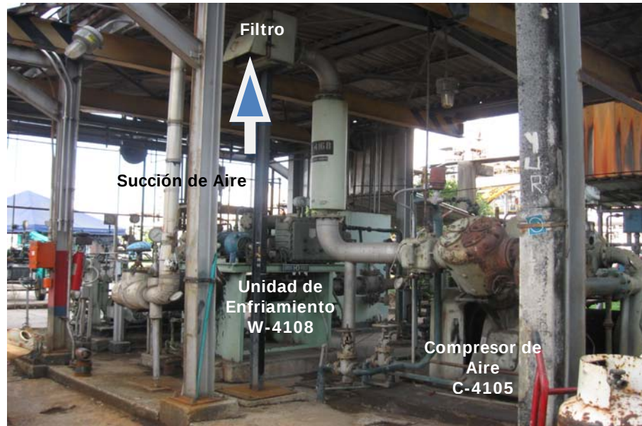
Figura 6. Área de compresores [1]
