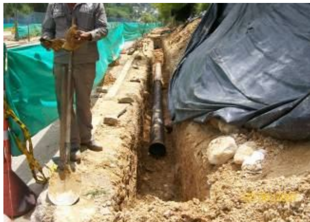
Redes de Alcantarillado frente a Bugarvilla.
