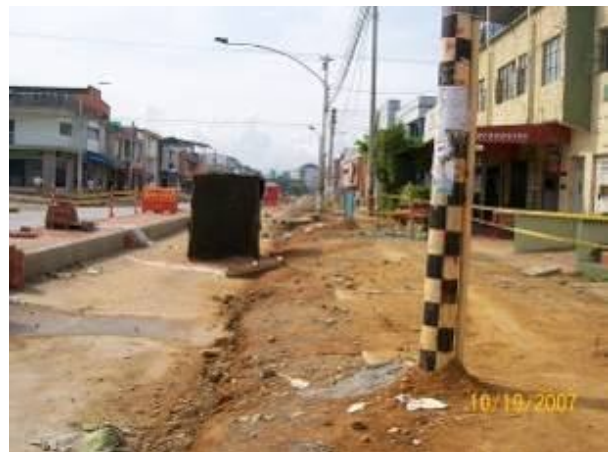
Postes de Energía que interfieren en carril derecho calzada occidental
