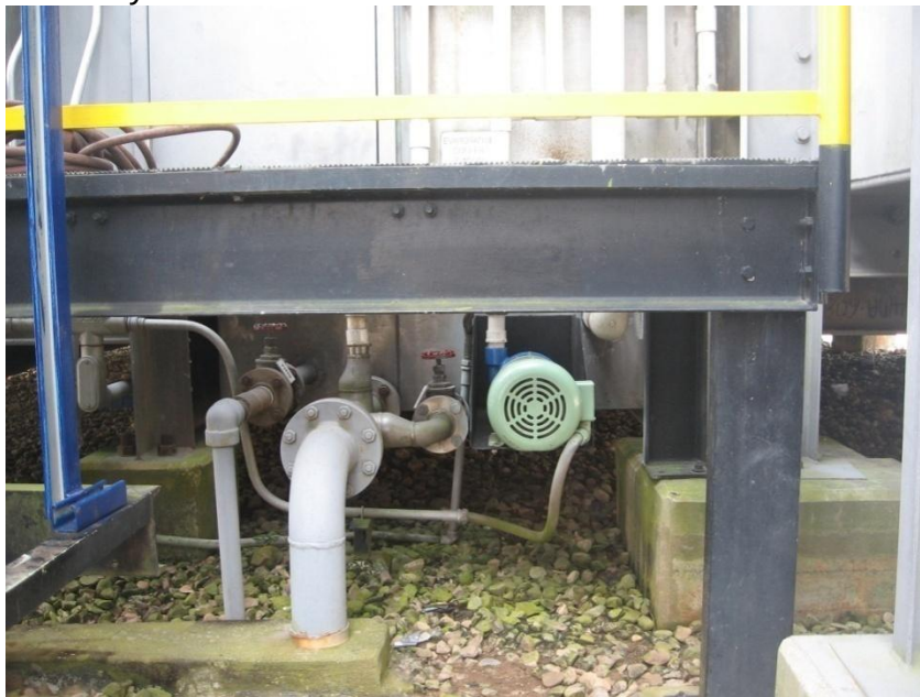
Figura 10. Motor y bombas del sistema
