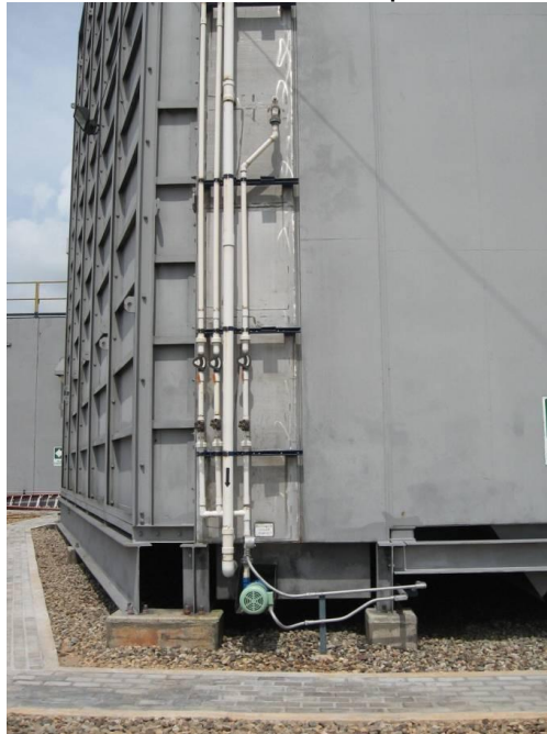
Figura 19. Vista General bomba enfriador evaporativo
