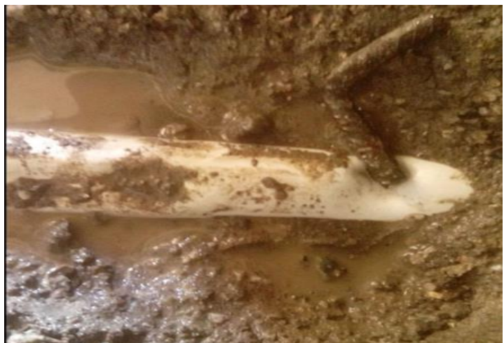
Figura 33 Daños en red hidráulica
