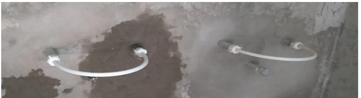
Figura 15 Conexión entre la red interna de agua caliente y agua fría
