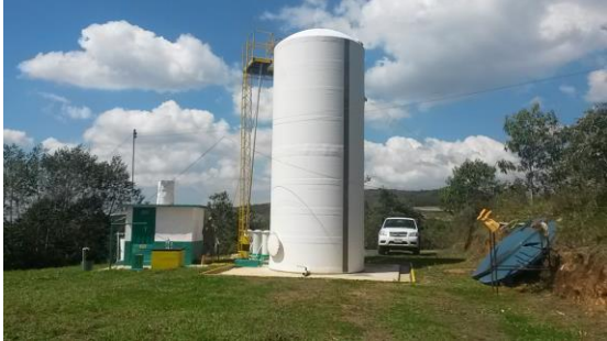
Foto 3.Sistema de potabilización y motobomba.
