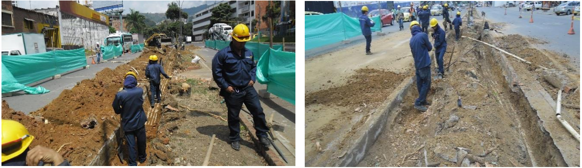
Figura. 10 Retiro, transporte y entrega en bodega de municipio de luminaria de sodio 150-250W en poste 8-12 mts.
