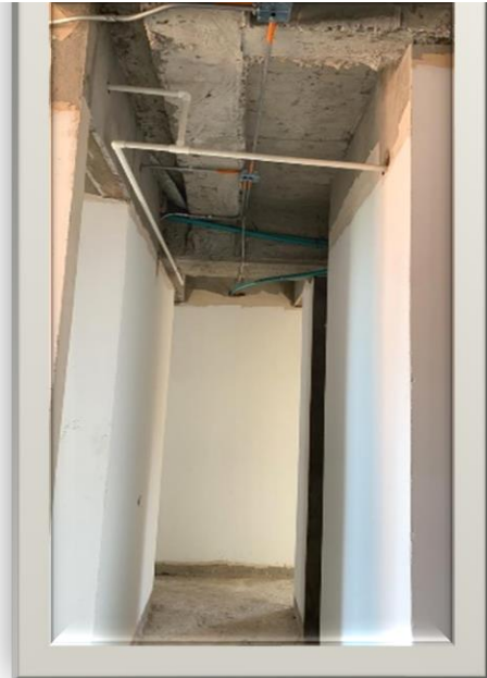
Ilustración 21-tubo del desagüe por debajo del nivel del cielo raso (interferencia)
