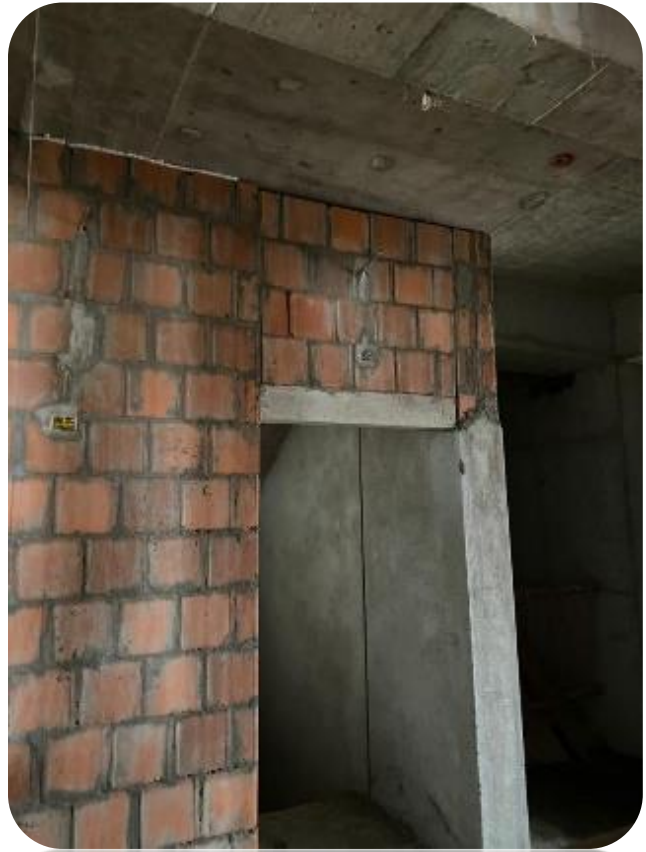
Ilustración 11-ladrillos sin traba en la parte superior del dintel
